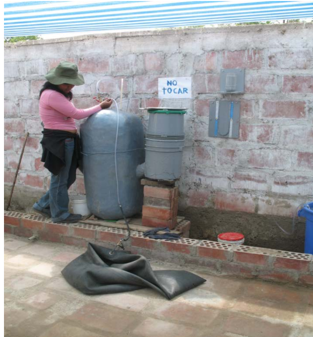
Foto 04: Cámara de llanta N° 20 para almacenar biogas
