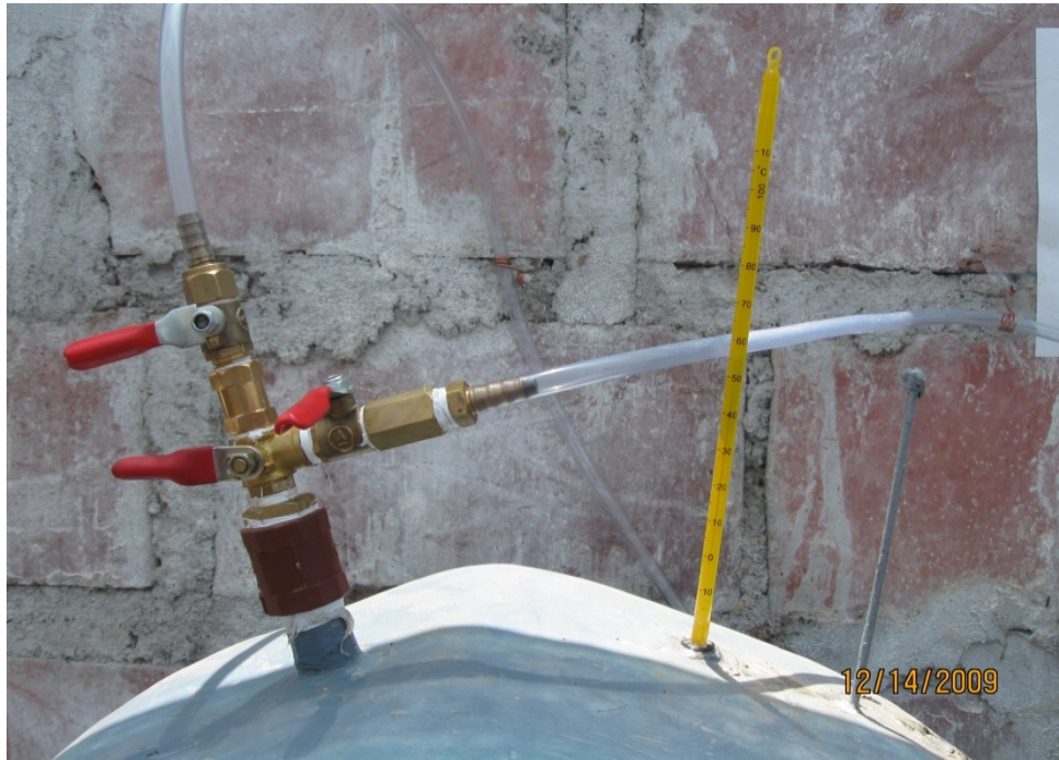
ANEXO 09: Domo superior del Biodigestor donde se observa; el termómetro y las llaves de paso que permiten la salida de biogas del Biodigestor, uno al Manómetro y otro al Gasómetro
