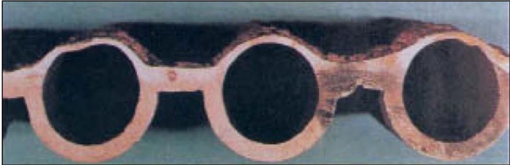
Figura 4. Severa pérdida de metal en los tubos de pared (Herro & Port, 1997).
