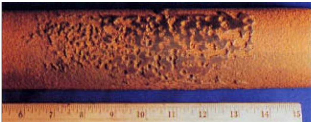
Figura 6. Corrosión por inactividad de la caldera (Herro & Port, 1997).
