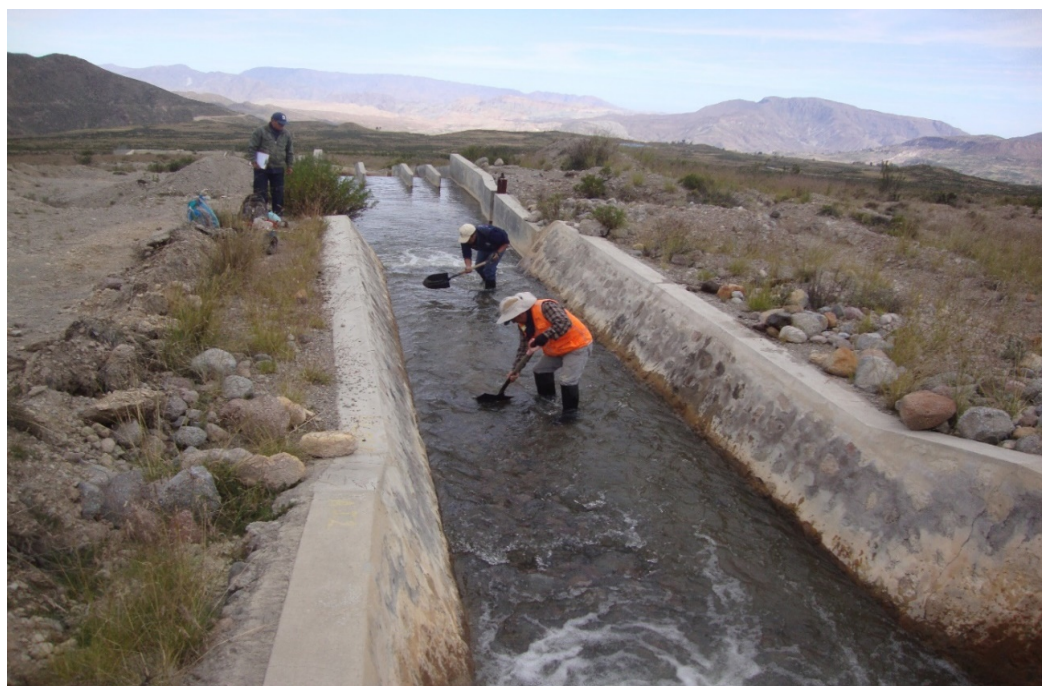
Vista panorámica: Infraestructura hidráulica, repartidor Marisol, a 3800 msnm. Distribución de agua para riego a los distritos de Candarave, Cairani, Huanuara y Quilahuani de la provincia de Candarave.
