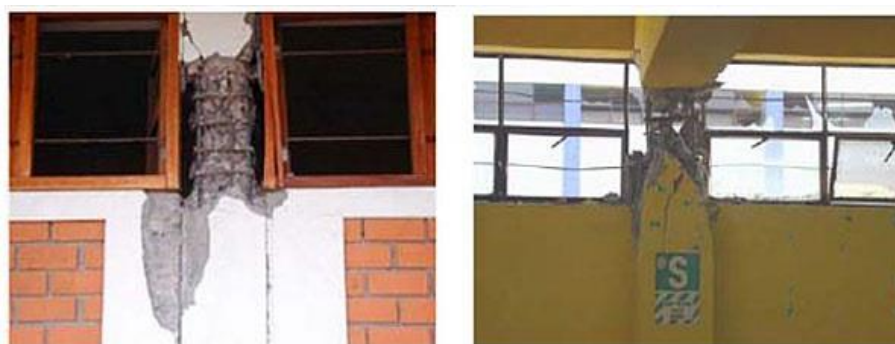
Figura 2. 6: Efecto columna corta en sismos por falta de juntas de dilatación en columna-muro.
