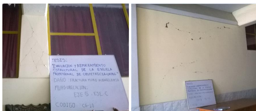
Figura 4. 4: Fisuras en muros de albañilería del 2do Nivel. Fuente: Elaboración propia, 2 017.
