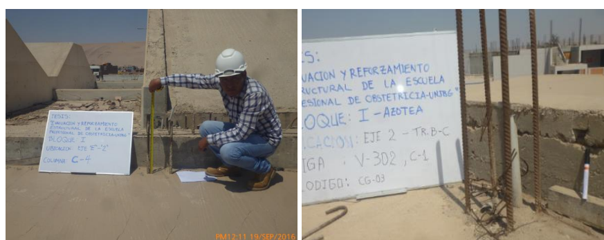
Figura 4. 3: Defectos constructivos en azotea del edificio. Fuente: Elaboración propia, 2 017.
