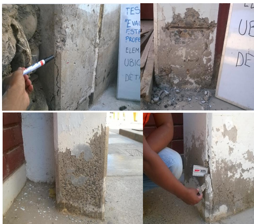
Figura 4. 5: Daños en columnas del 1er nivel. Fuente: Elaboración propia, 2 017.
