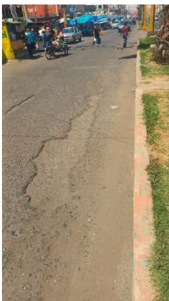
Unidad de muestreo U40 hueco de severidad alta
