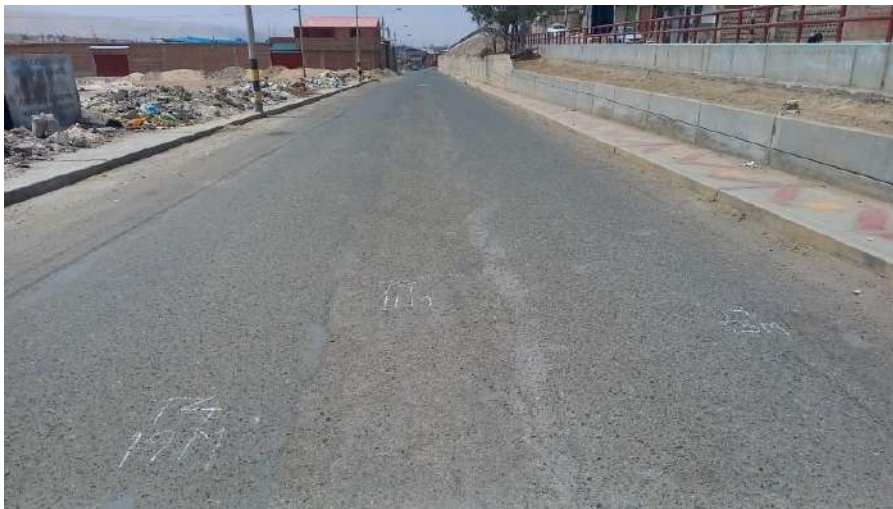
Unidad de muestreo U4 meteorización de agregados de severidad media
