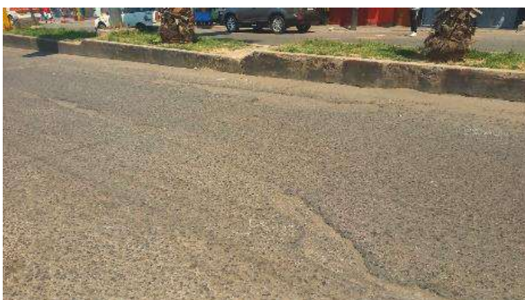
Unidad de muestreo U40 huecos de alta severidad
