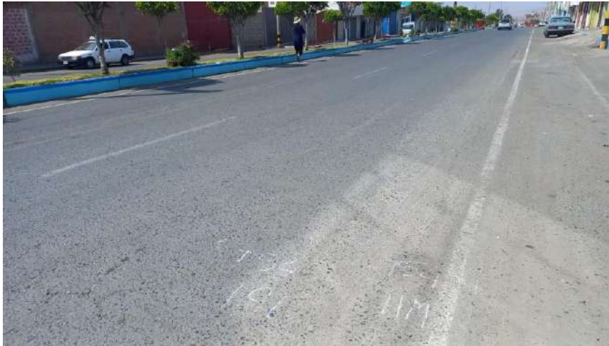
Unidad de muestreo U54 meteorización de agregados de severidad leve y parcheo de severidad media
