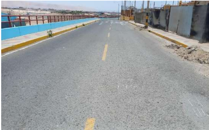
Unidad de muestreo U9 meteorización de agregados de severidad media
