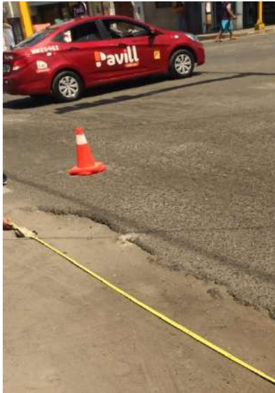
Unidad de muestreo U24 grieta de borde de severidad alta
