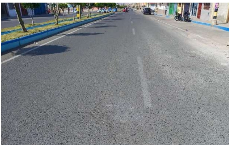
Unidad de muestreo U44 fisura de severidad media
