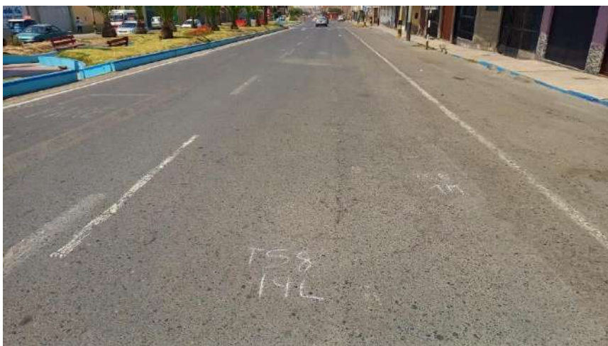
Unidad de muestreo U58 meteorización de agregados de severidad leve
