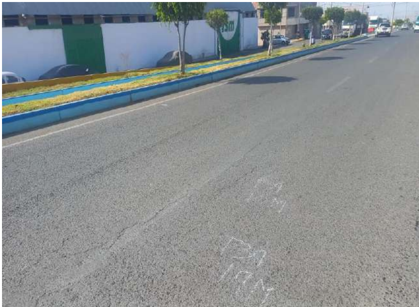
Unidad de muestreo U39 meteorización de agregados y fisura de severidad media
