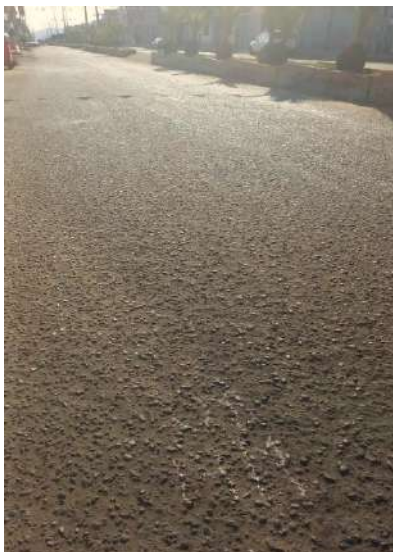
Unidad de muestreo U8 meteorización de agregados de media severidad
