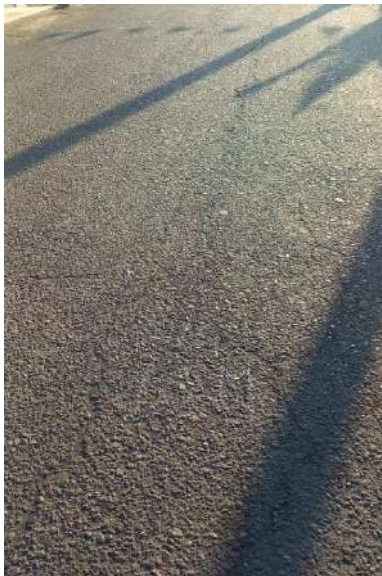
Unidad de muestreo U16 fisuras longitudinales de media severidad
