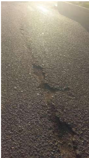
Unidad de muestreo U20 hueco de severidad alta
