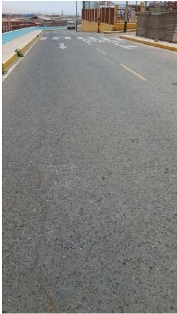
Unidad de muestreo U9 fisura longitudinal de severidad media
