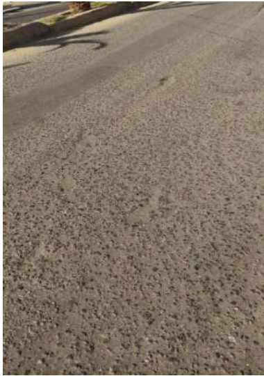
Unidad de muestreo U8 meteorización de agregados de alta severidad
