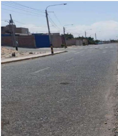
Unidad de muestreo U20 meteorización de agregados de severidad media
