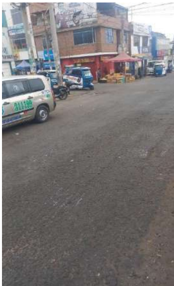
Unidad de muestreo U48 meteorización de agregados de alta y media severidad
