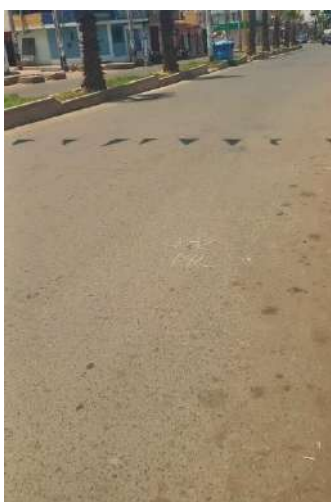
Unidad de muestreo U32 meteorización de agregados de severidad leve
