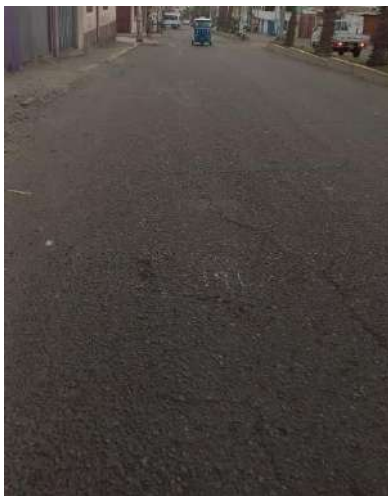
Unidad de muestreo U28 meteorización de agregados de severidad leve
