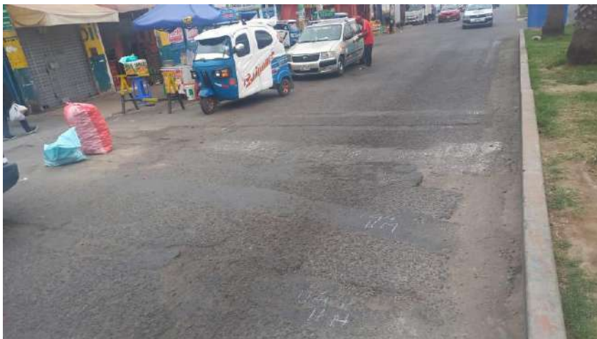
Unidad de muestreo U44 parcheo de alta y media severidad y meteorización de agregados de alta severidad
