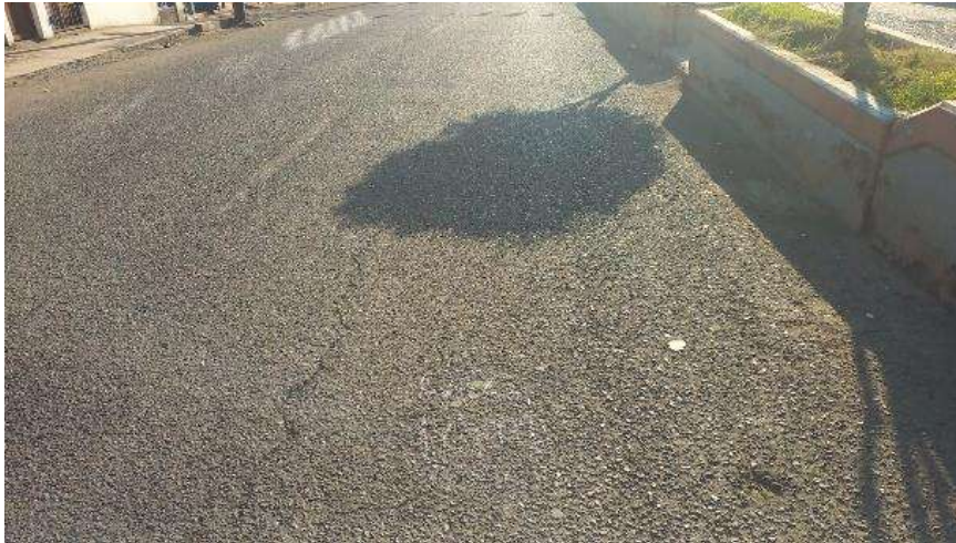
Unidad de muestreo U12 fisura longitudinal de media severidad
