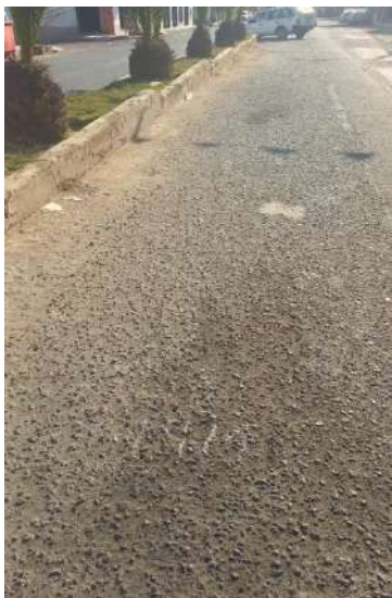
Unidad de muestreo U8 meteorización de agregados de media severidad
