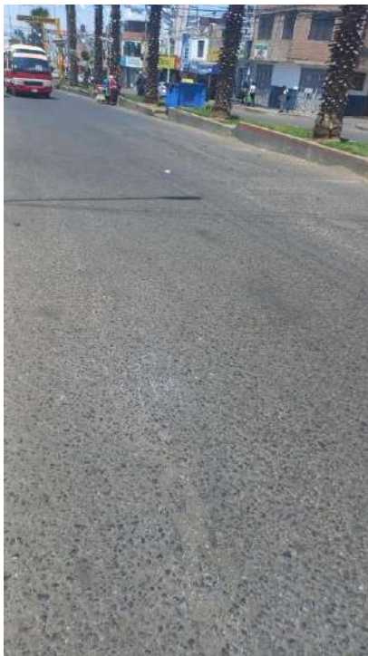
Unidad de muestreo U39 meteorización de agregados de media severidad
