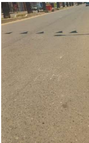
Unidad de muestreo U32 grieta longitudinal de severidad media y meteorización de agregados de severidad media
