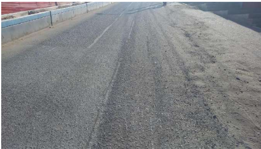
Unidad de muestreo U6 meteorización de agregados de severidad media
