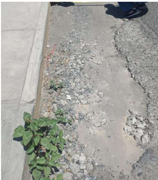
Unidad de muestreo U29 hueco de severidad alta
