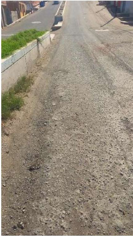
Unidad de muestreo U4 hueco de alta severidad
