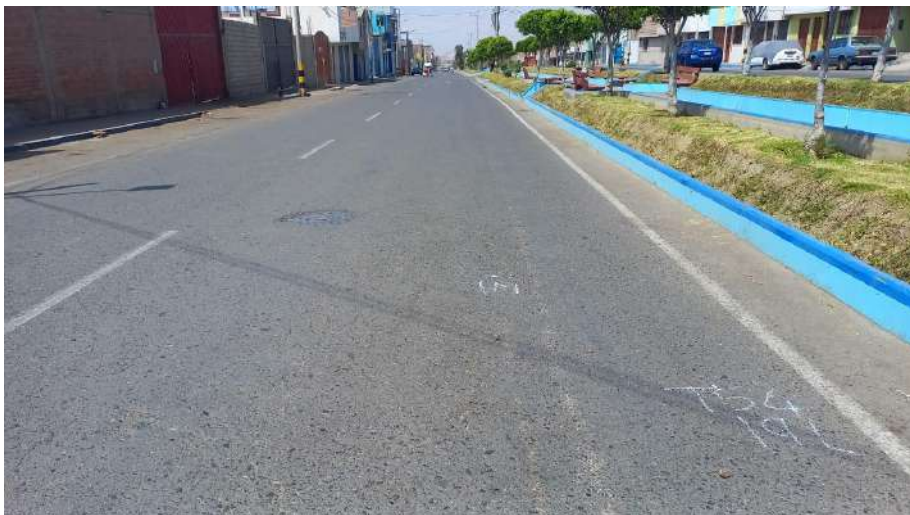
Unidad de muestreo U54 meteorización de agregados de severidad leve
