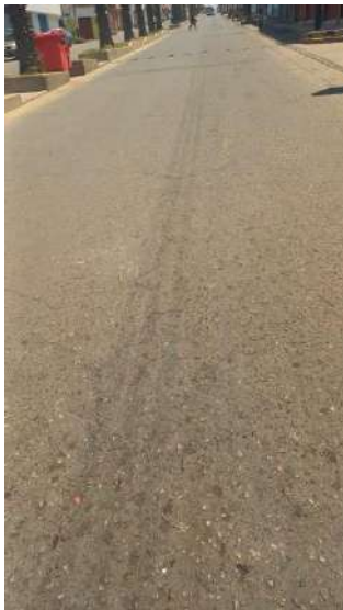
Unidad de muestreo U32 agrietamiento en bloque de severidad media
