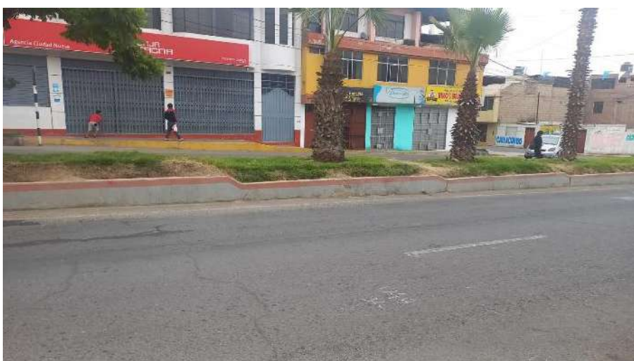
Unidad de muestreo U48 agrietamiento en bloque de severidad baja
