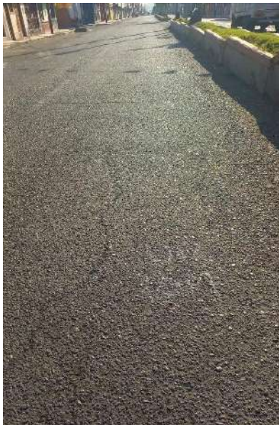
Unidad de muestreo U12 grieta longitudinal de media severidad
