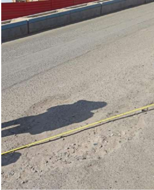
Unidad de muestreo U6 hueco de alta severidad
