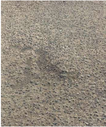
Unidad de muestreo U4 huecos de severidad leve
