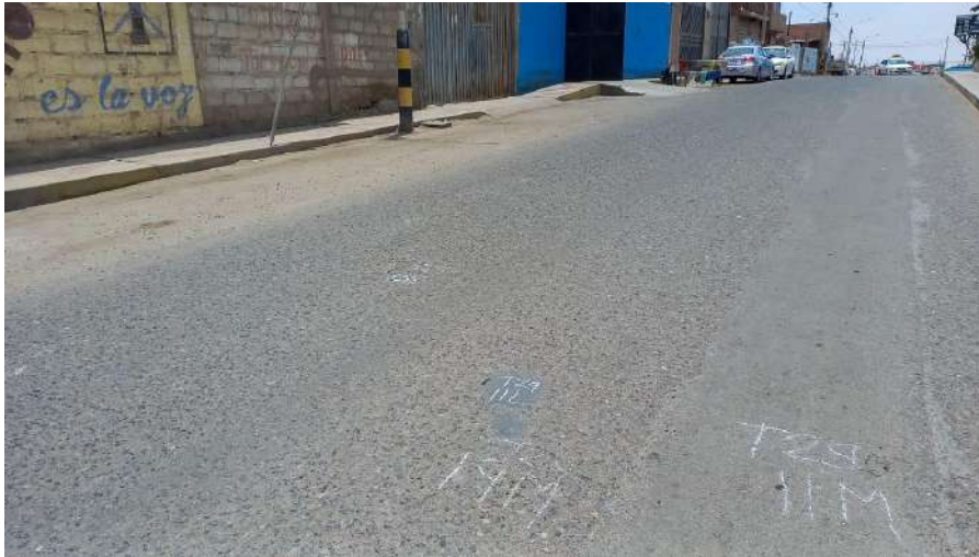
Unidad de muestreo U29 meteorización de agregados y parcheo de severidad media
