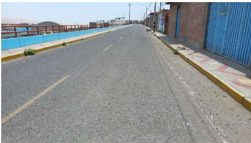
Unidad de muestreo U19 meteorización de agregados de severidad media
