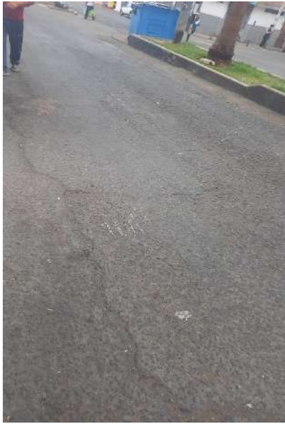
Unidad de muestreo U44 fisura longitudinal de alta severidad
