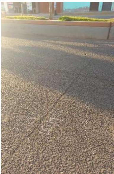
Unidad de muestreo U20 grieta transversal de severidad media
