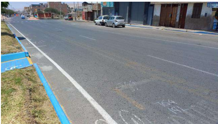
Unidad de muestreo U64 meteorización de agregados de severidad leve
