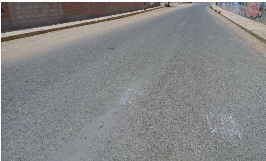
Unidad de muestreo U19 meteorización de agregados de severidad media
