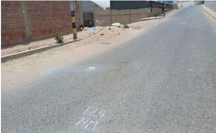
Unidad de muestreo U24 meteorización de agregados de severidad media
