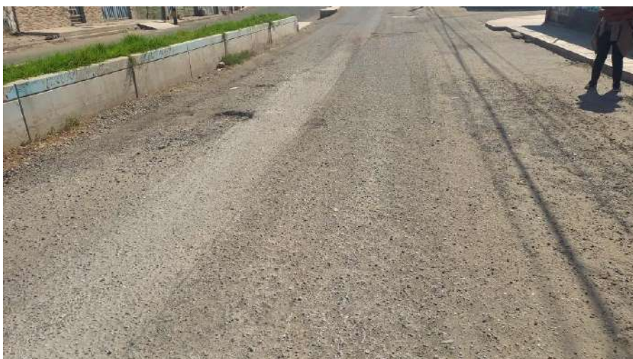
Unidad de muestreo U4 meteorización de agregados de alta severidad
