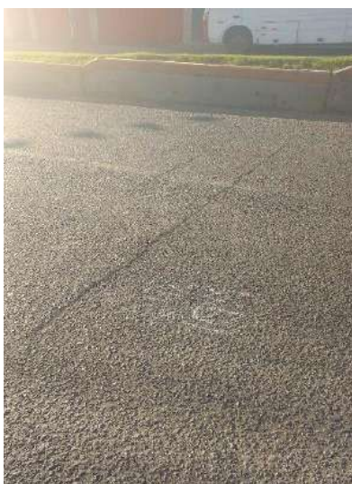
Unidad de muestreo U12 grieta transversal de media severidad
