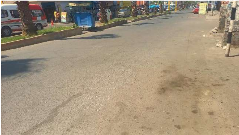
Unidad de muestreo U40 meteorización de agregados de severidad media
