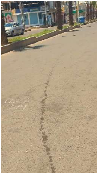
Unidad de muestreo U32 agrietamiento en bloque de media severidad
