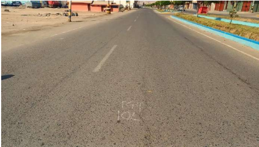
Unidad de muestreo U49 fisura de severidad leve
