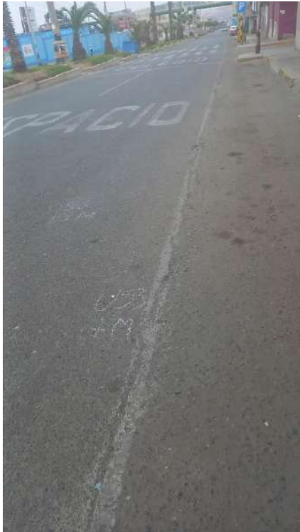
Unidad de muestreo U53 grieta de borde de severidad media
