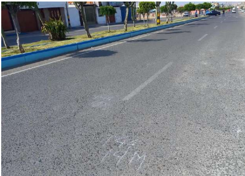
Unidad de muestreo U44 meteorización de agregados de severidad media
