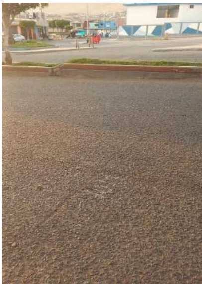
Unidad de muestreo U24 grieta transversal de severidad media y meteorización de agregados de media severidad
