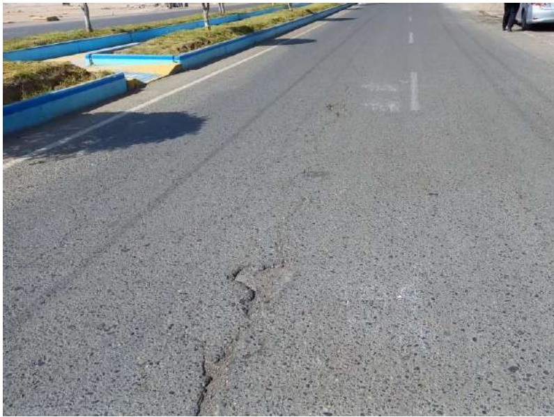
Unidad de muestreo U49 fisuras y huecos de severidad media
