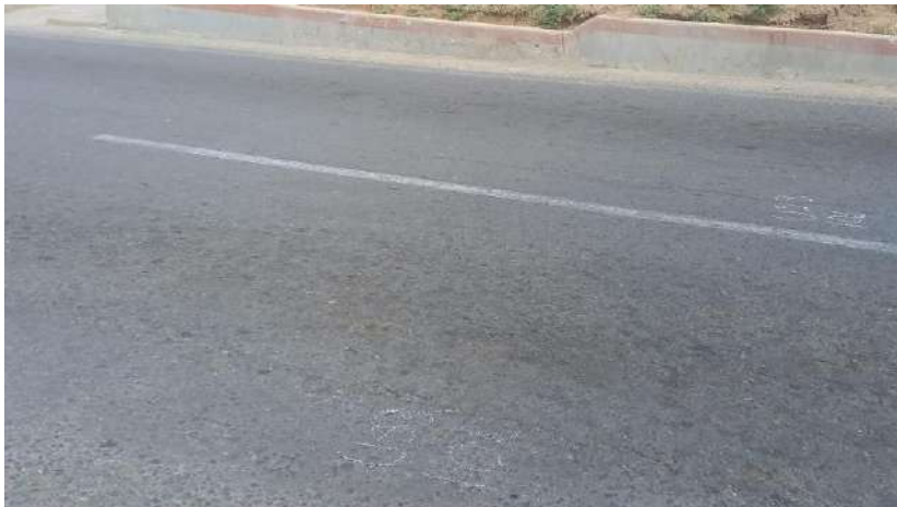
Unidad de muestreo U53 fisuras longitudinales de leve y media severidad
