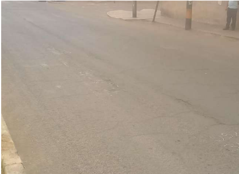
Unidad de muestreo U52 agrietamiento en bloque de severidad leve
