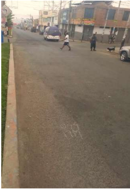
Unidad de muestreo U44 meteorización de agregados de severidad media
