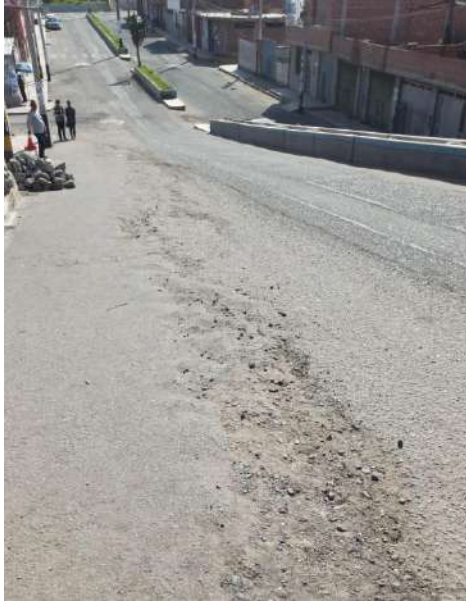
Unidad de muestreo U6 meteorización de agregados de severidad alta
