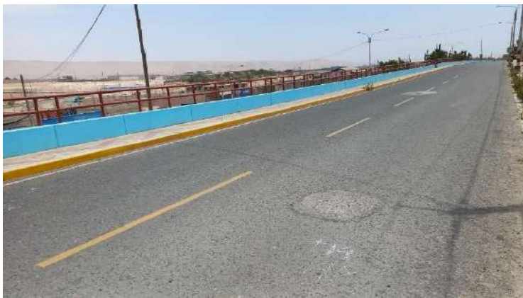
Unidad de muestreo U14 meteorización de agregados de severidad media
