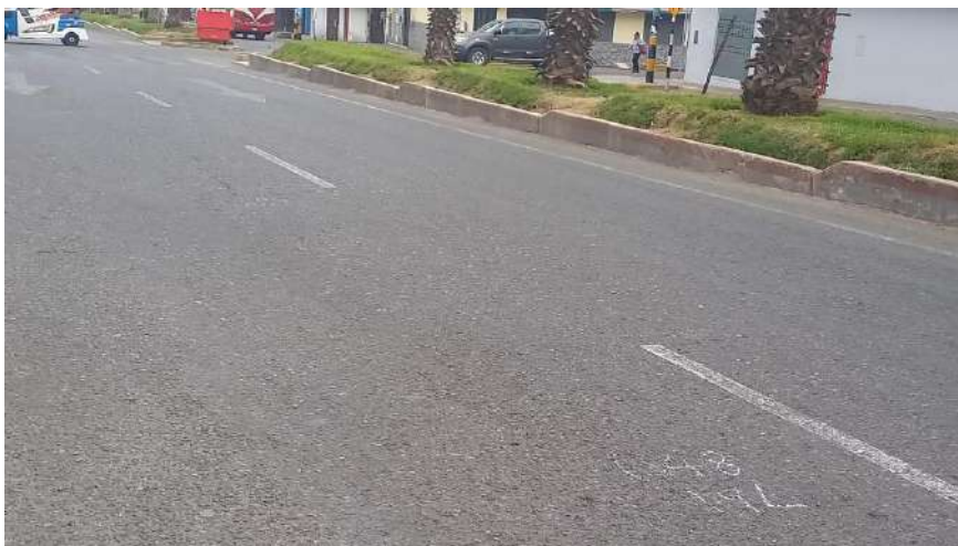
Unidad de muestreo U48 meteorización de agregados de severidad leve
