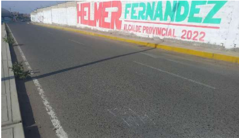
Unidad de muestreo U34 meteorización de agregados de severidad media
