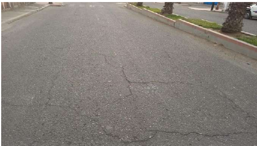
Unidad de muestreo U28 agrietamiento en bloque de severidad media
