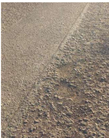
Unidad de muestreo U16 huecos de severidad leve
