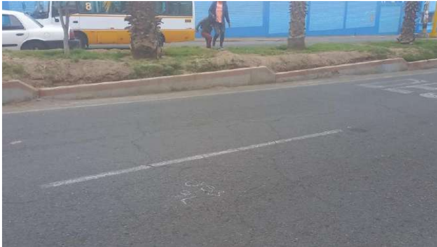
Unidad de muestreo U53 agrietamiento en bloque de severidad leve
