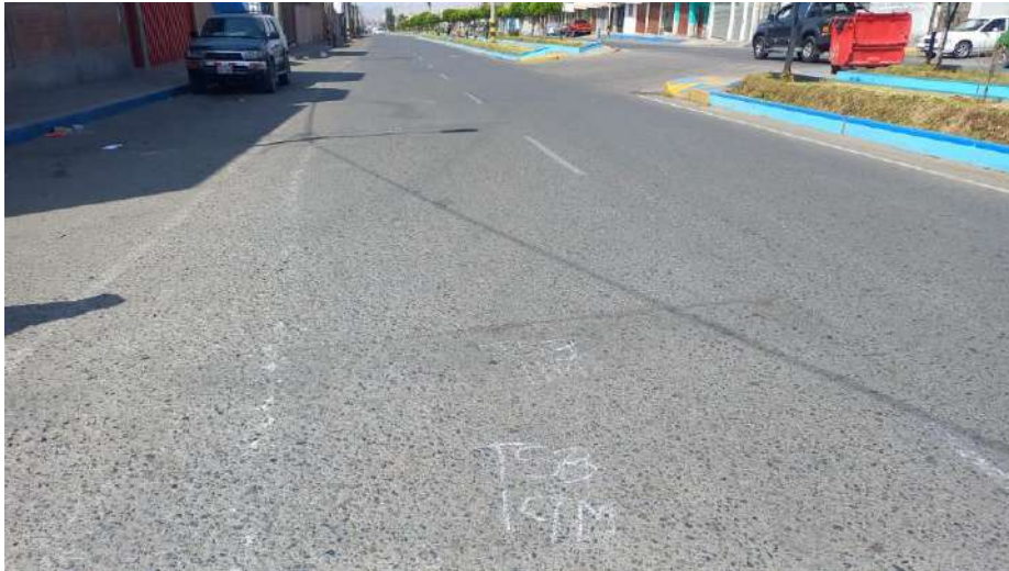
Unidad de muestreo U53 meteorización de agregados de severidad media
