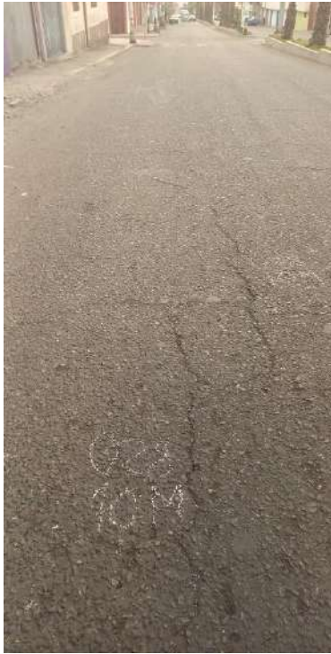
Unidad de muestreo U28 grietas longitudinales de severidad media
