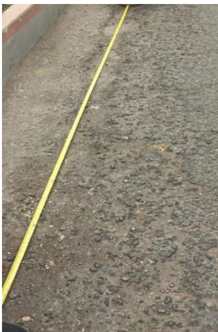
Unidad de muestreo U36 meteorización de agregados de severidad alta
