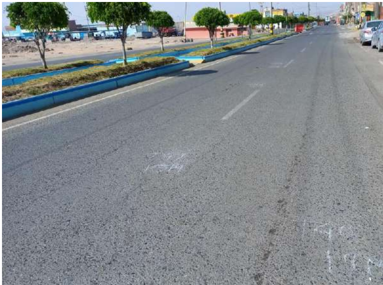
Unidad de muestreo U49 meteorización de agregados y fisura de severidad media
