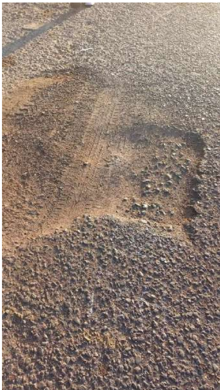
Unidad de muestreo U22 hueco de severidad alta
