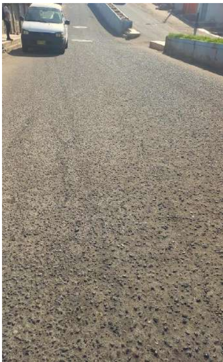
Unidad de muestreo U4 meteorización de agregados de media severidad
