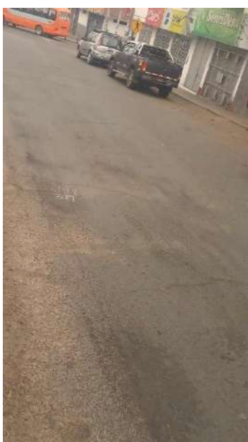
Unidad de muestreo U44 agrietamiento en bloque de severidad media
