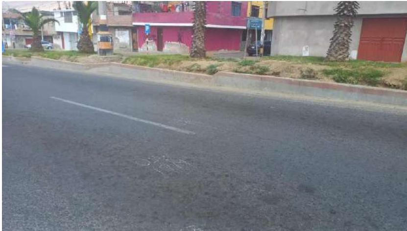
Unidad de muestreo U52 meteorización de agregados de media severidad
