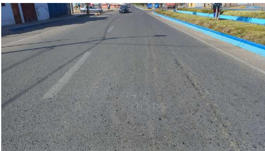
Unidad de muestreo U44 fisura de severidad media
