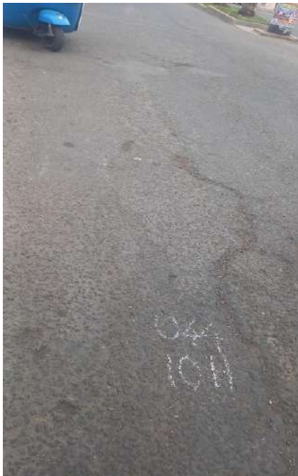
Unidad de muestreo U44 fisura de alta severidad
