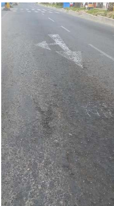
Unidad de muestreo U52 meteorización de agregados de alta severidad
