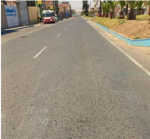
Unidad de muestreo U59 fisuras de media y leve severidad
