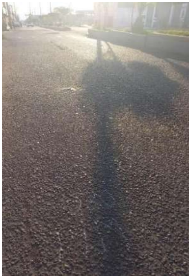
Unidad de muestreo U20 meteorización de agregados de media severidad
