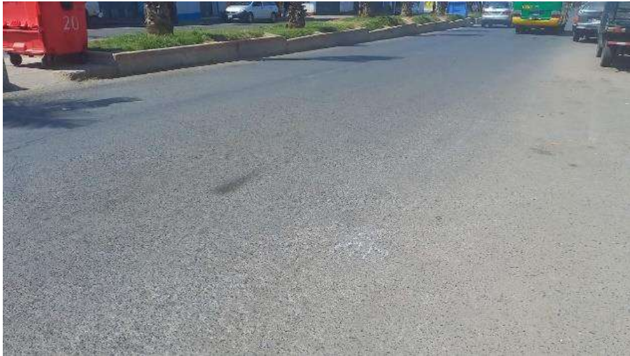
Unidad de muestreo U46 meteorización de agregados de severidad media
