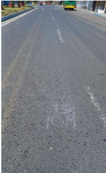
Unidad de muestreo U59 fisura longitudinal de severidad media
