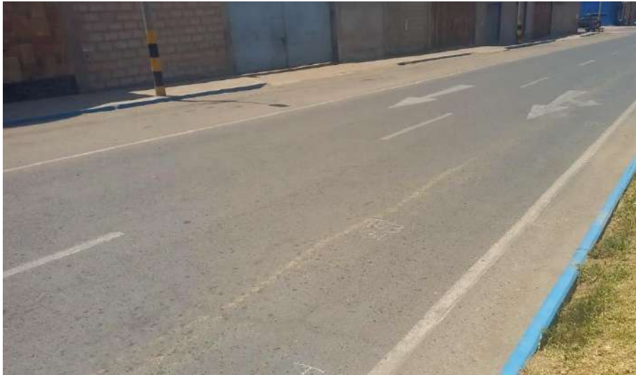
Unidad de muestreo U63 agrietamiento en bloque de severidad leve
