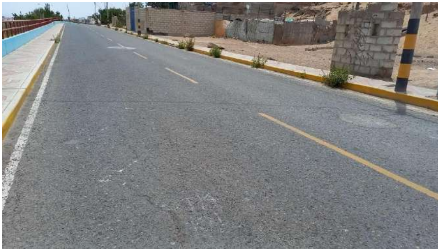
Unidad de muestreo U14 fisura de severidad leve
