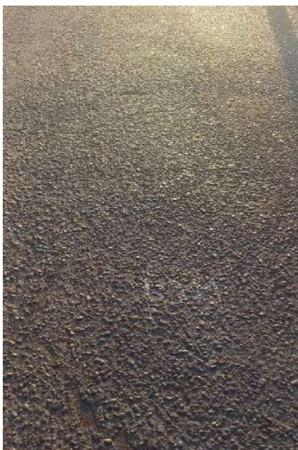
Unidad de muestreo U22 fisura longitudinal de severidad media
