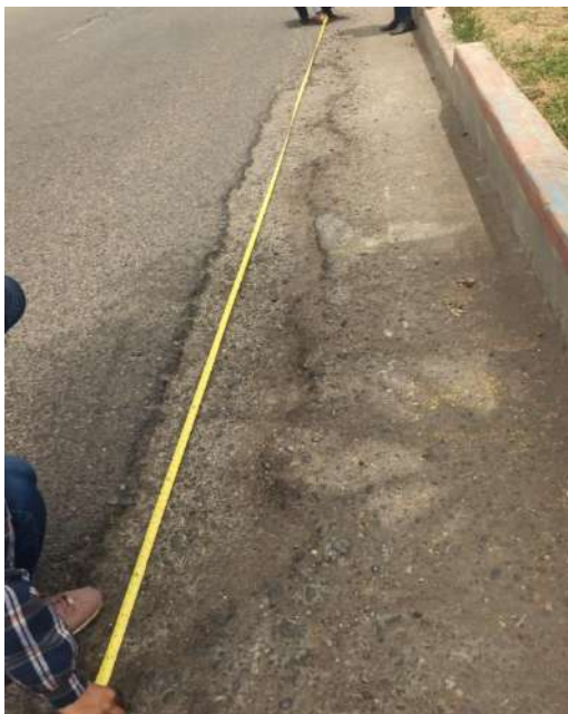
Unidad de muestreo U36 hueco de severidad alta
