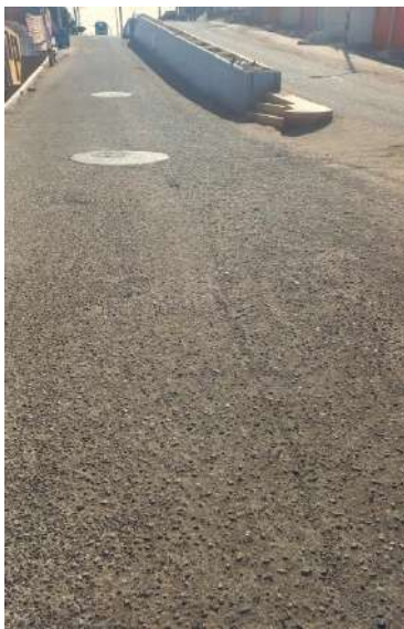
Unidad de muestreo U4 grieta longitudinal de severidad media
