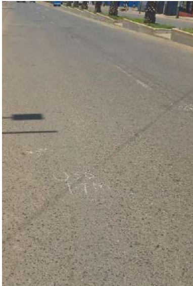
Unidad de muestreo U36 meteorización de agregados de severidad media
