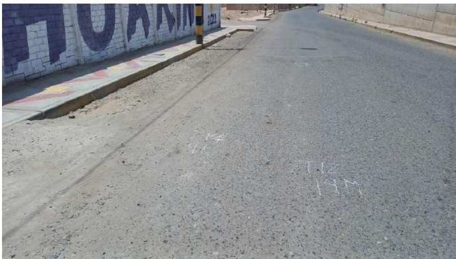
Unidad de muestreo U12 meteorización de agregados de severidad media
