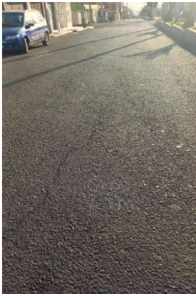
Unidad de muestreo U16 grieta longitudinal de media severidad
