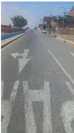
Unidad de muestreo U4 meteorización de agregados de severidad leve
