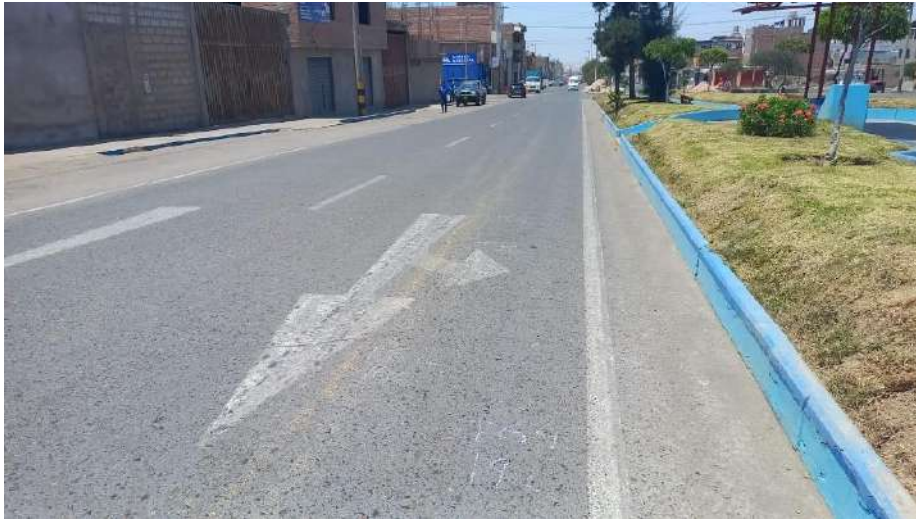
Unidad de muestreo U64 fisuras de severidad leve
