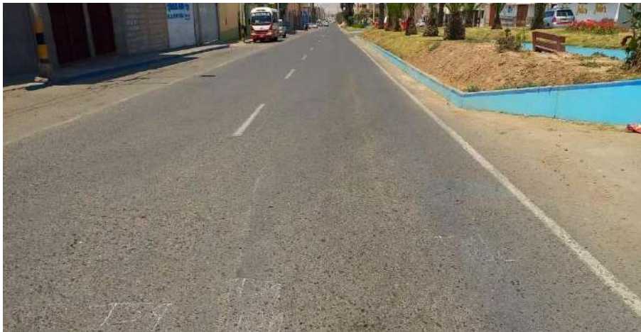
Unidad de muestreo U59 meteorización de agregados de severidad leve
