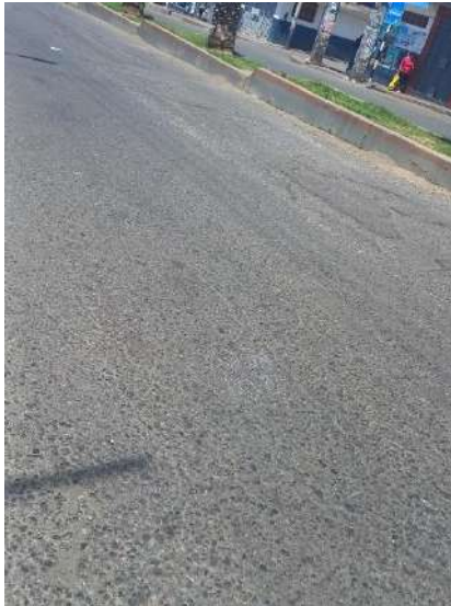
Unidad de muestreo U39 fisura de severidad leve
