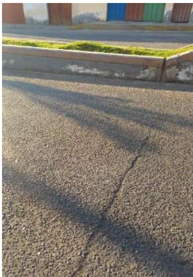
Unidad de muestreo U16 grieta transversal de media severidad
