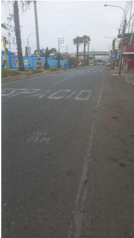
Unidad de muestreo U53 meteorización de agregados de severidad media
