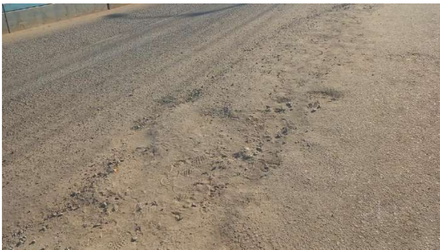
Unidad de muestreo U6 hueco de severidad alta
