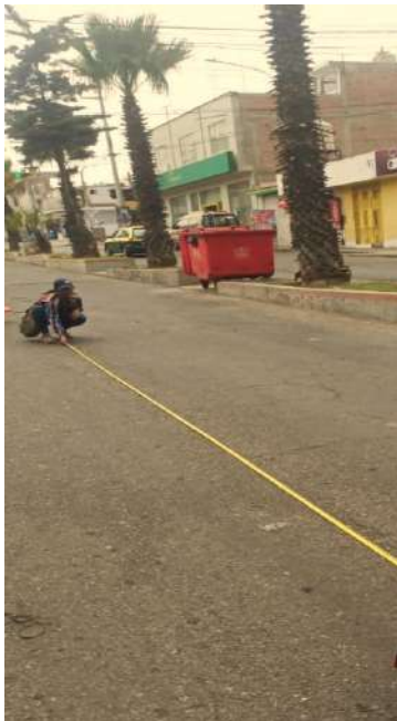
Unidad de muestreo U36 agrietamiento en bloque de severidad leve
