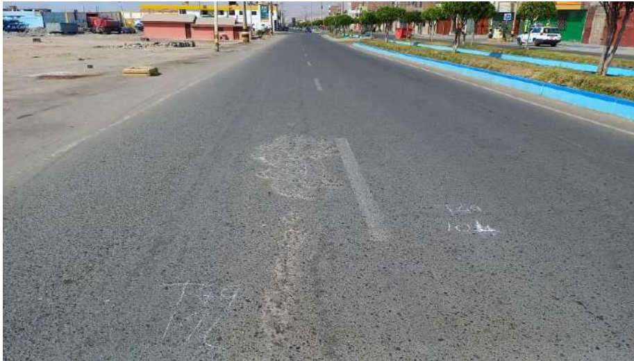
Unidad de muestreo U49 meteorización de agregados de severidad y fisura de severidad leve
