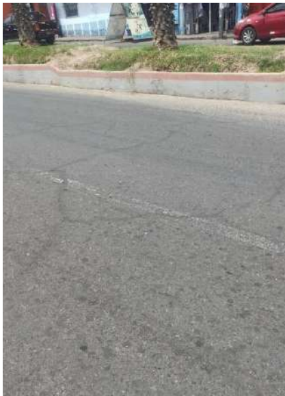
Unidad de muestreo U46 agrietamiento en bloque de severidad media
