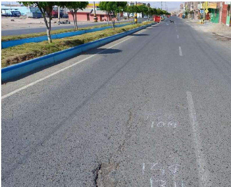
Unidad de muestreo U49 hueco y fisura de severidad media
