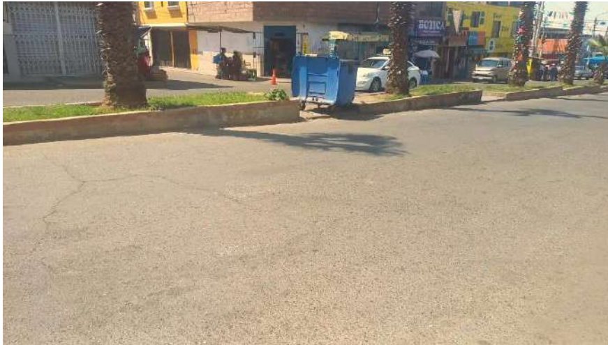
Unidad de muestreo U40 agrietamiento en bloque de severidad media
