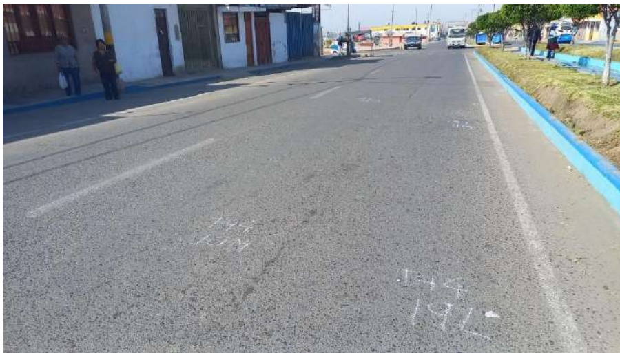
Unidad de muestreo U44 meteorización de agregados de severidad leve y fisura de severidad media
