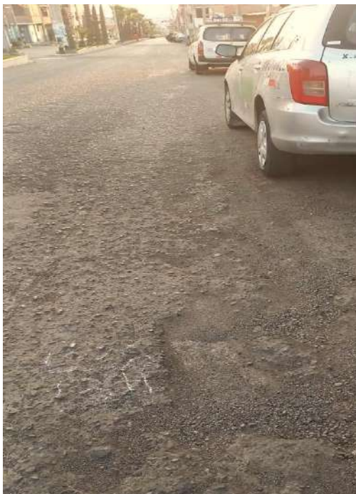
Unidad de muestreo U28 hueco de alta severidad
