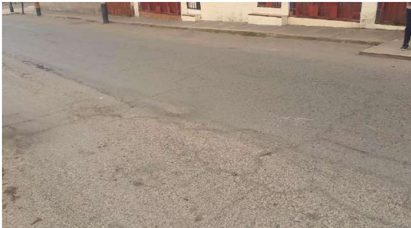
Unidad de muestreo U52 agrietamiento en bloque de severidad media
