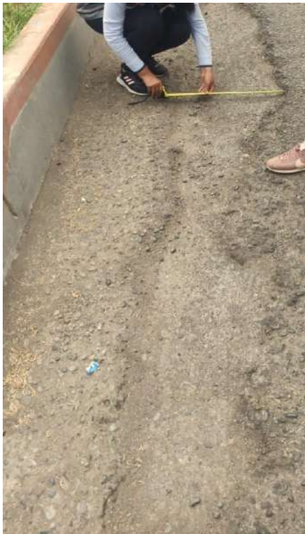
Unidad de muestreo U36 hueco de alta severidad
