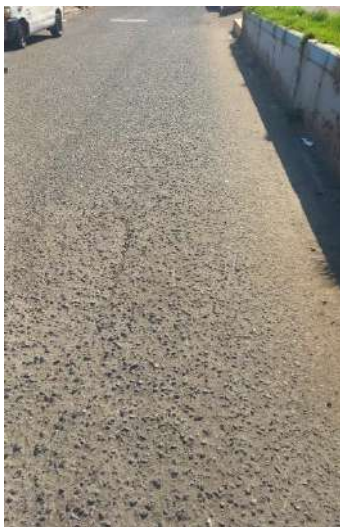
Unidad de muestreo U4 grieta longitudinal de severidad leve
