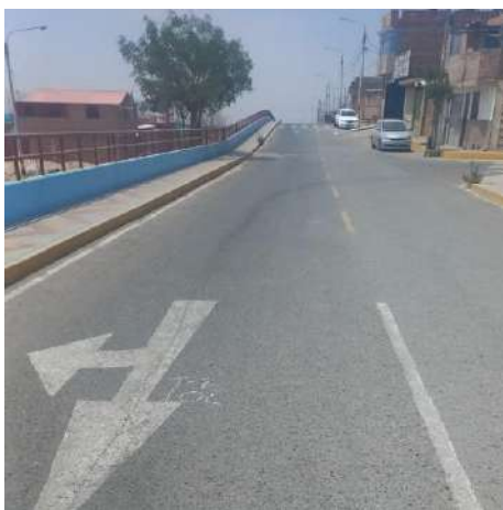
Unidad de muestreo U4 fisura de severidad leve
