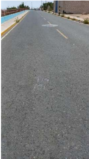
Unidad de muestreo U14 fisura longitudinal de severidad leve
