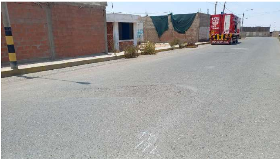
Unidad de muestreo U14 meteorización de agregados de severidad leve
