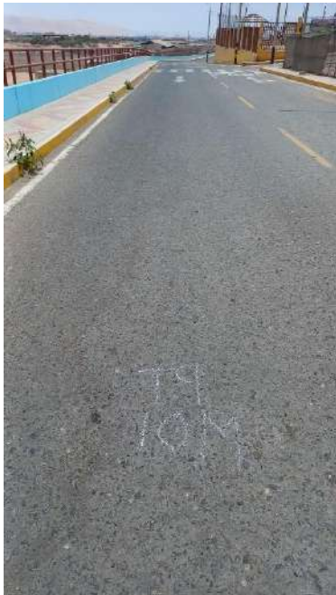
Unidad de muestreo U9 fisura de severidad media
