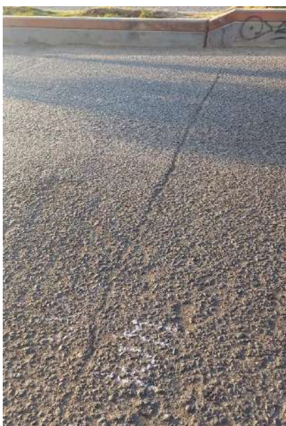
Unidad de muestreo U22 fisura transversal de severidad media
