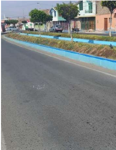
Unidad de muestreo U39 fisura de severidad leve
