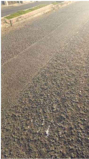
Unidad de muestreo U16 meteorización de agregados de severidad media
