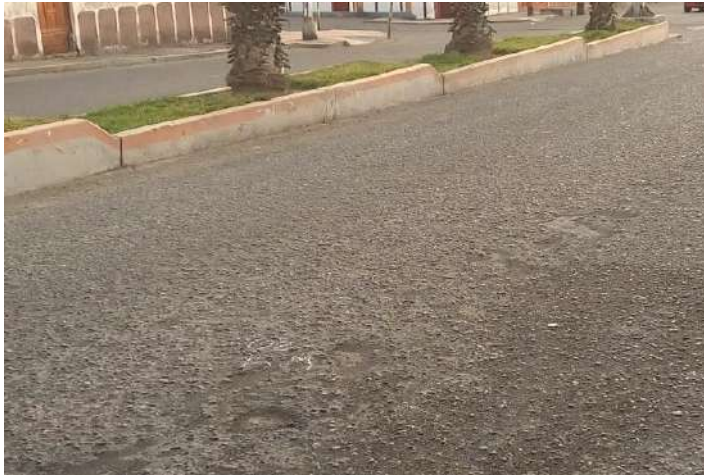
Unidad de muestreo U28 huecos de severidad media y meteorización de agregado de severidad media
