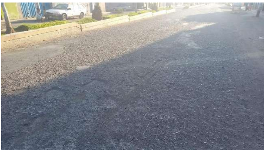
Unidad de muestreo U6 huecos de alta severidad
