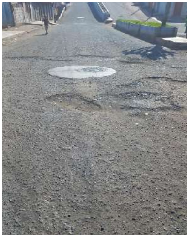
Unidad de muestreo U3 huecos de alta severidad
