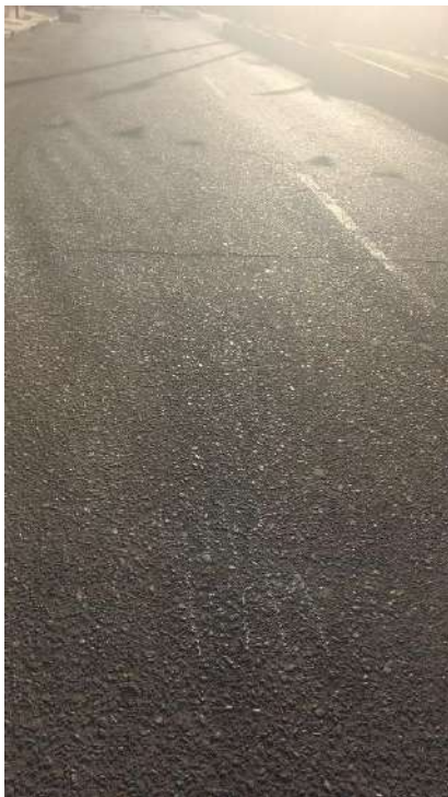
Unidad de muestreo U12 meteorización de agregados de media severidad
