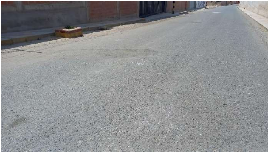
Unidad de muestreo U9 meteorización de agregados de severidad media
