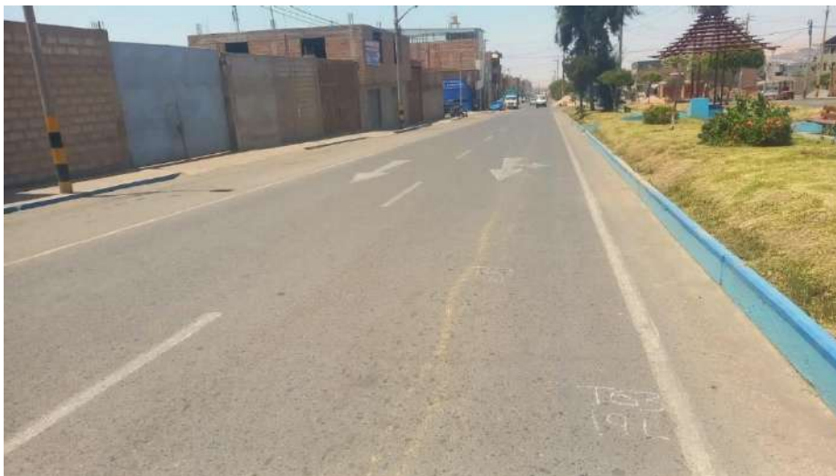
Unidad de muestreo U63 meteorización de agregados de severidad leve
