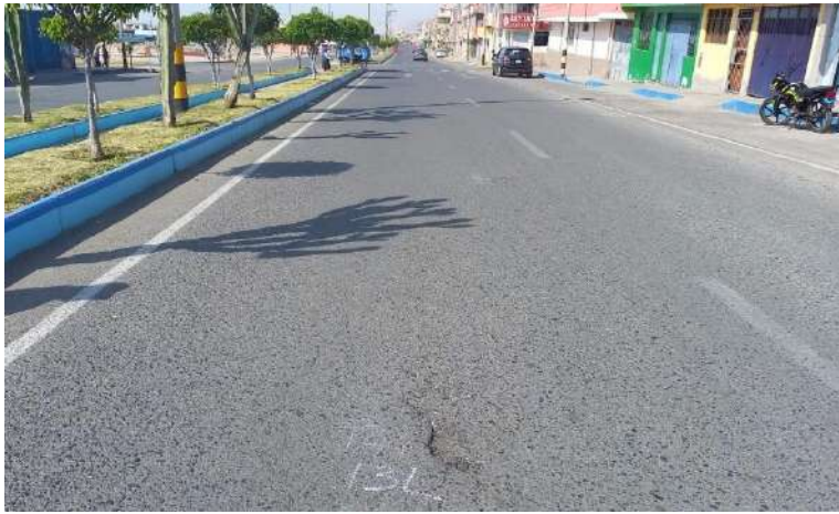
Unidad de muestreo U44 huecos de severidad leve
