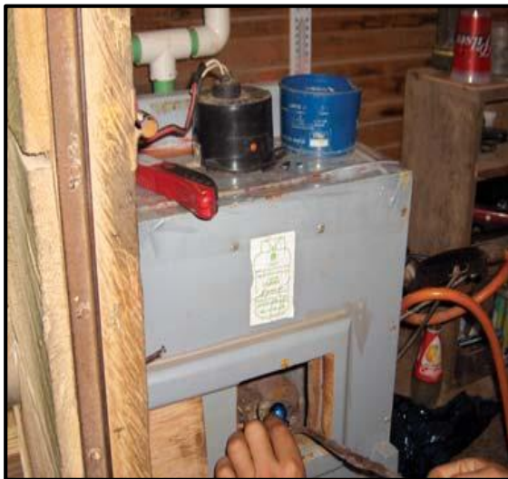
Figura 17. Depurador en seco de mercurio
