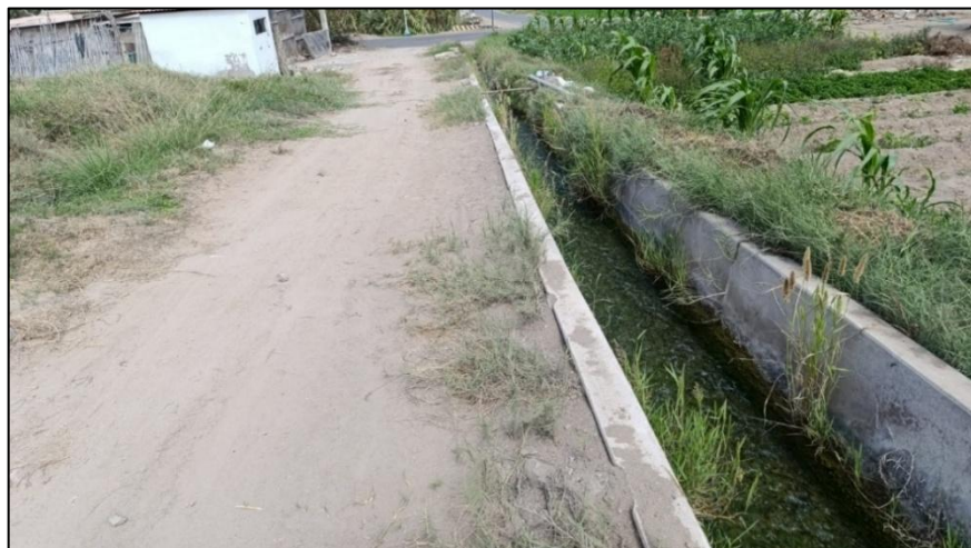
Presencia de vegetación adherida a la solera del canal trapezoidal lateral "C"
