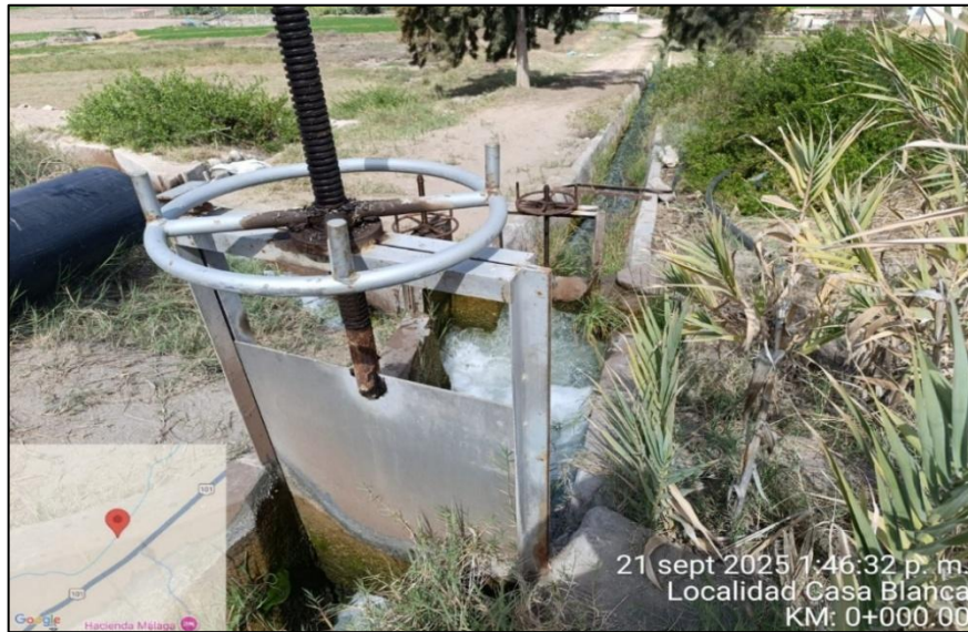
Condición estructural del marco de la compuerta de captación del canal trapezoidal lateral "C"
