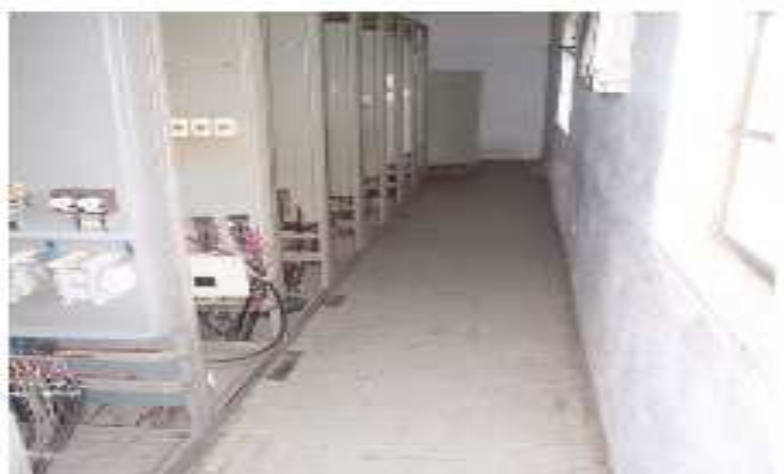
Figura N° 27: Áreas de Trabajo sin Señalización de Seguridad
