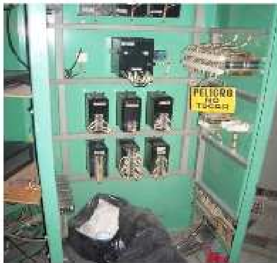
Figura 3. Señalización Limitada en Tableros de Control
