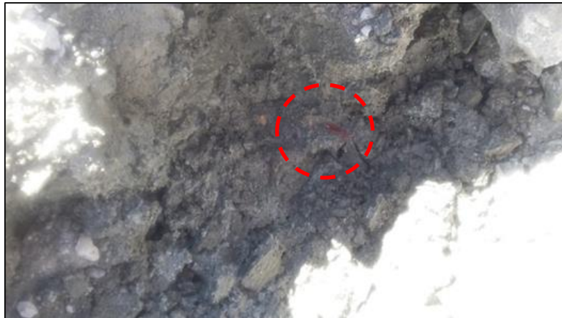
Figura 62. Identificación del booster en la excavación. Tiro quedado.
