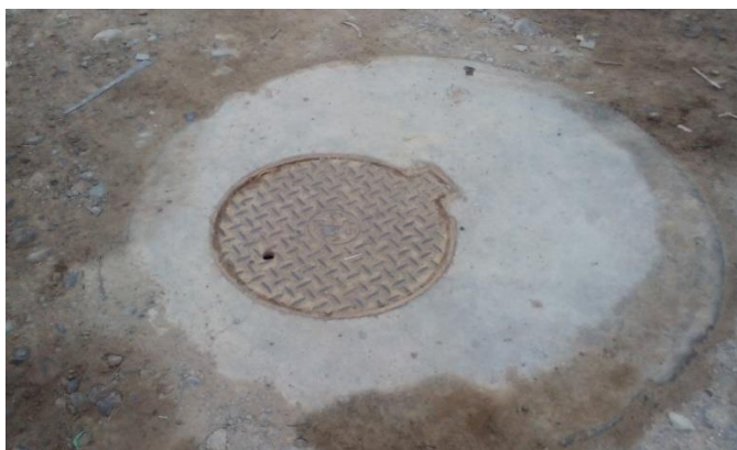
Figura 76: Vista buzón de desagüe – Vía Litoral
