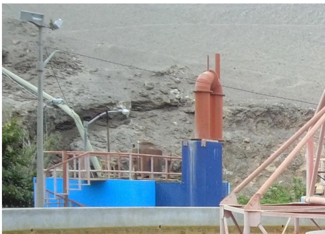
IMAGEN N° 33: Planta de tratamiento
