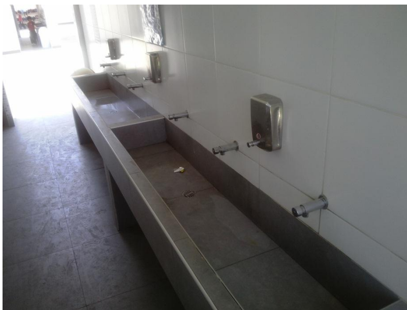
Grifos temporizados en los lavamanos
