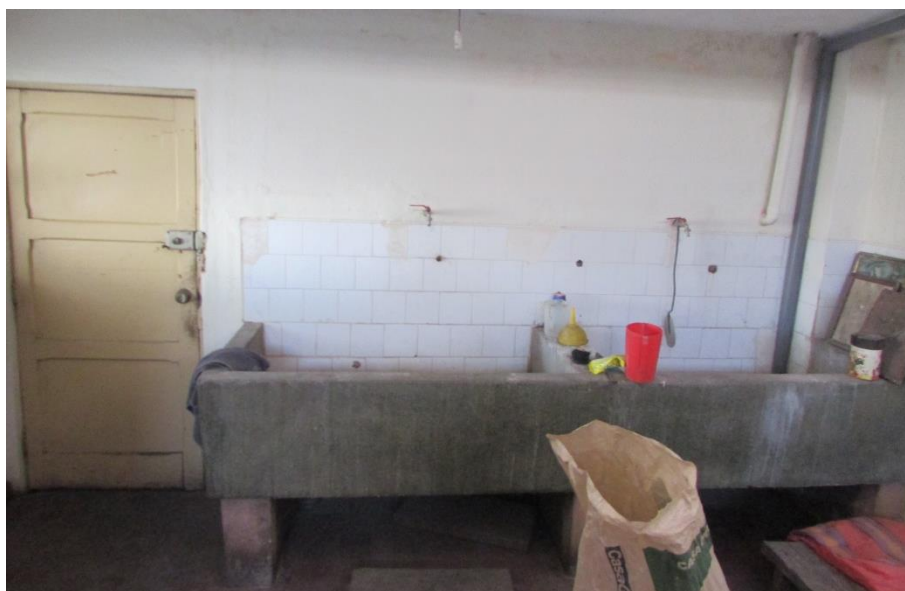
IMAGEN 10. Instalaciones de agua originales en el Centro de Alimentación y Nutrición del Mercado “Dos de Mayo”
