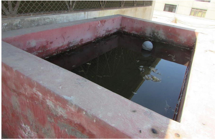
IMAGEN 13. Abastecimiento de agua, tanque cisterna para el PRONOEI de la JJ.VV. Francisco Antonio de Zela.
