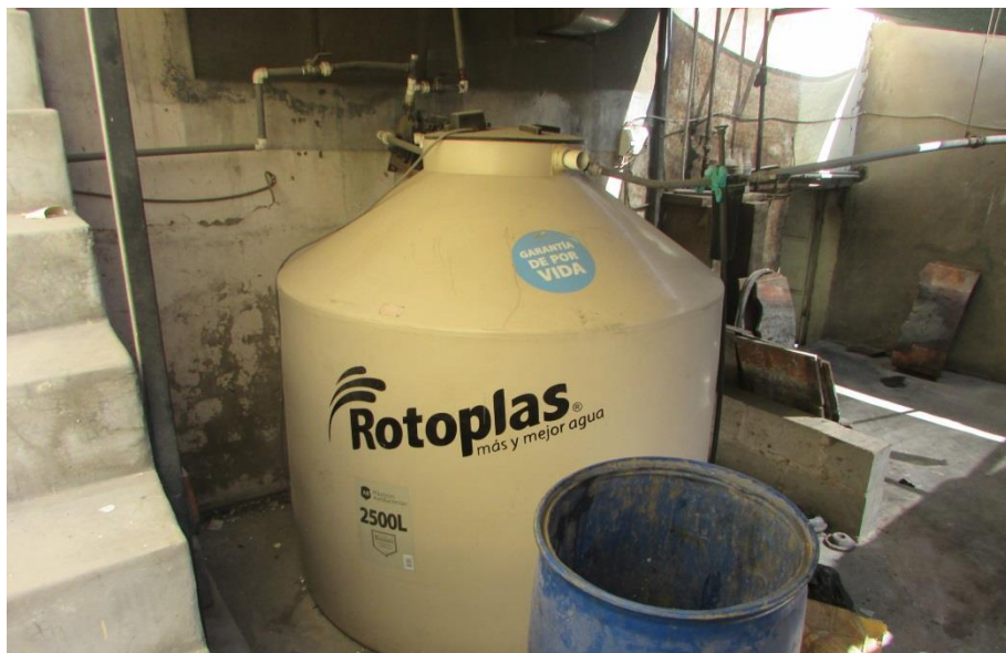
IMAGEN 12. Abastecimiento de agua, tanque elevado en el Centro de Alimentación y Nutrición del mercado “Dos de Mayo” Fuente propia
