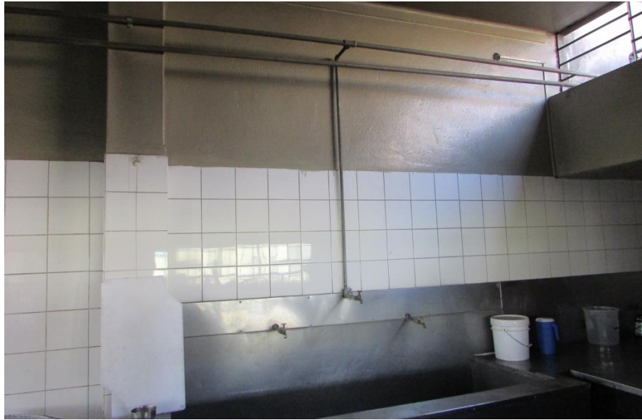
IMAGEN 11. Instalaciones exteriores de agua en el Centro de Alimentación y Nutrición del Mercado “Dos de Mayo” Fuente propia
