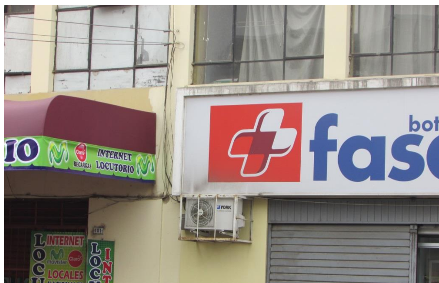
IMAGEN 17. Instalaciones eléctricas exteriores en el Mercado “Dos de Mayo”, del lado de la Av. Dos de Mayo Fuente Propia
