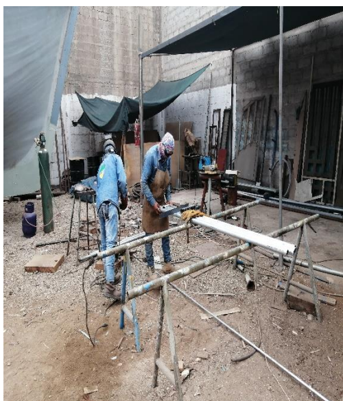
Figura 5. Personal de soldadura, no usa los EPP correspondientes.
