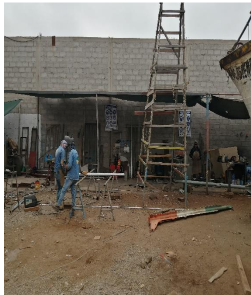
Figura 6. Área de soldadura, le falta orden y limpieza
