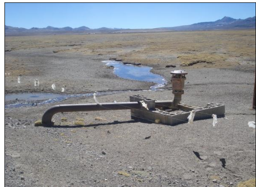
Pozo de extracción de agua TP
