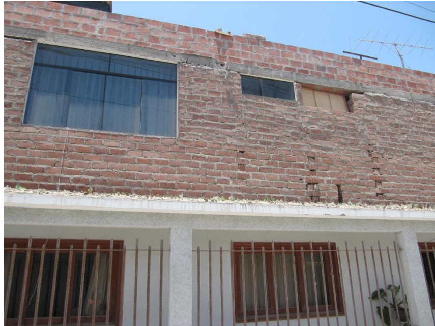
Fotografía 3: Muros de borde sin confinamiento
