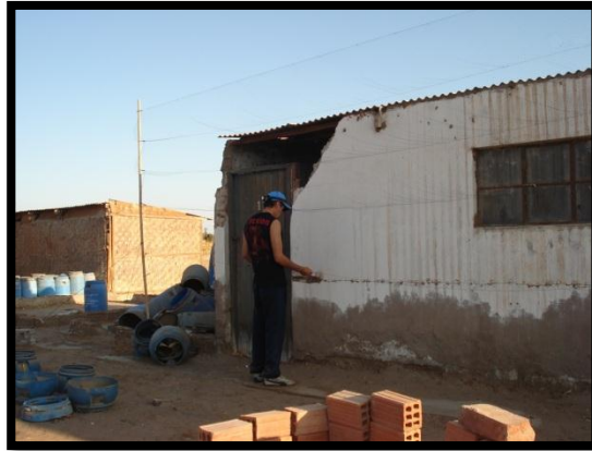
ANEXO 14: Instalación de las mallas en “Los Palos” en el Fundo denominado “Las lagunas”.
