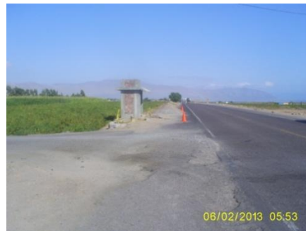
Progresiva 90+000, daño por acceso informal
