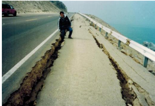
Asentamiento de la calzada km 72+000
