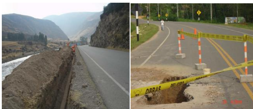
Invasiones en el Derecho de Vía
