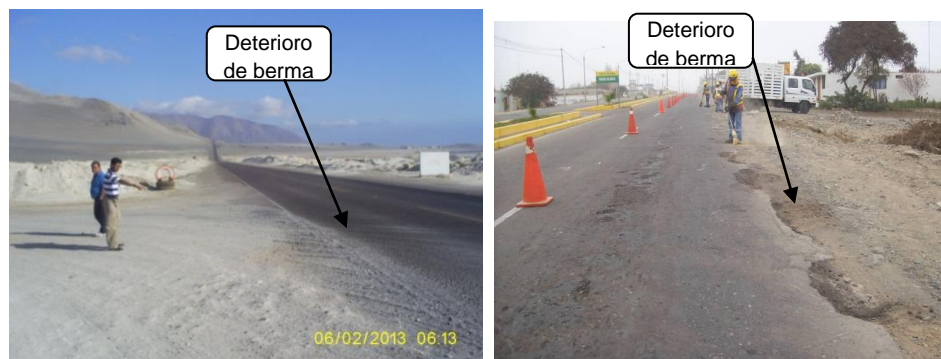
Construcción de acceso informal km 83+500, desprendimiento de material y peladuras de calzada y bermas
