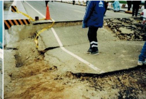
Asentamiento de la calzada km 42+000, Puente los Baños
