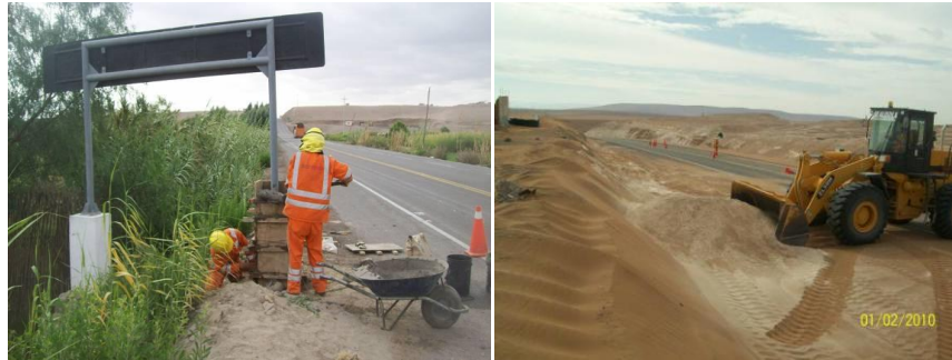
Se observa las dificultades que trae, al mantenimiento de la vía, las invasiones en el Derecho de Vía
