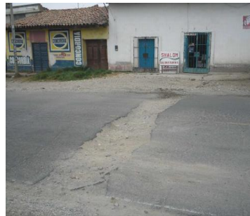
Fig. 2.2.B Daños en la carretera que incrementa los costos de operación de vehículos
