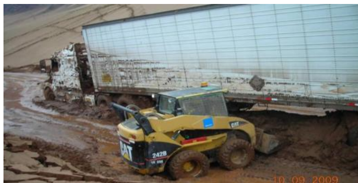
Progresiva Km 68+400, Deslizamiento de material, La Costanera Tacna – Ilo
