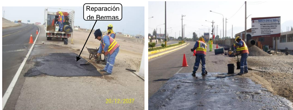
Desprendimiento de material y peladuras de calzada y bermas Fig. 3.3.2.N Reparación de bermas en material granular.
