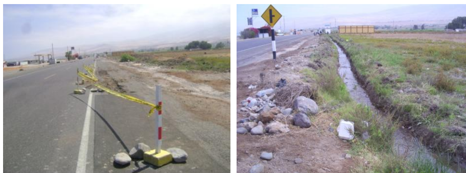
Fig. 1.2.B La Costanera km 90+000 daños a la carretera
