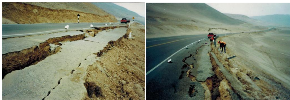
Deslizamiento de zonas aledañas a la carretera por sismo km 75+000
