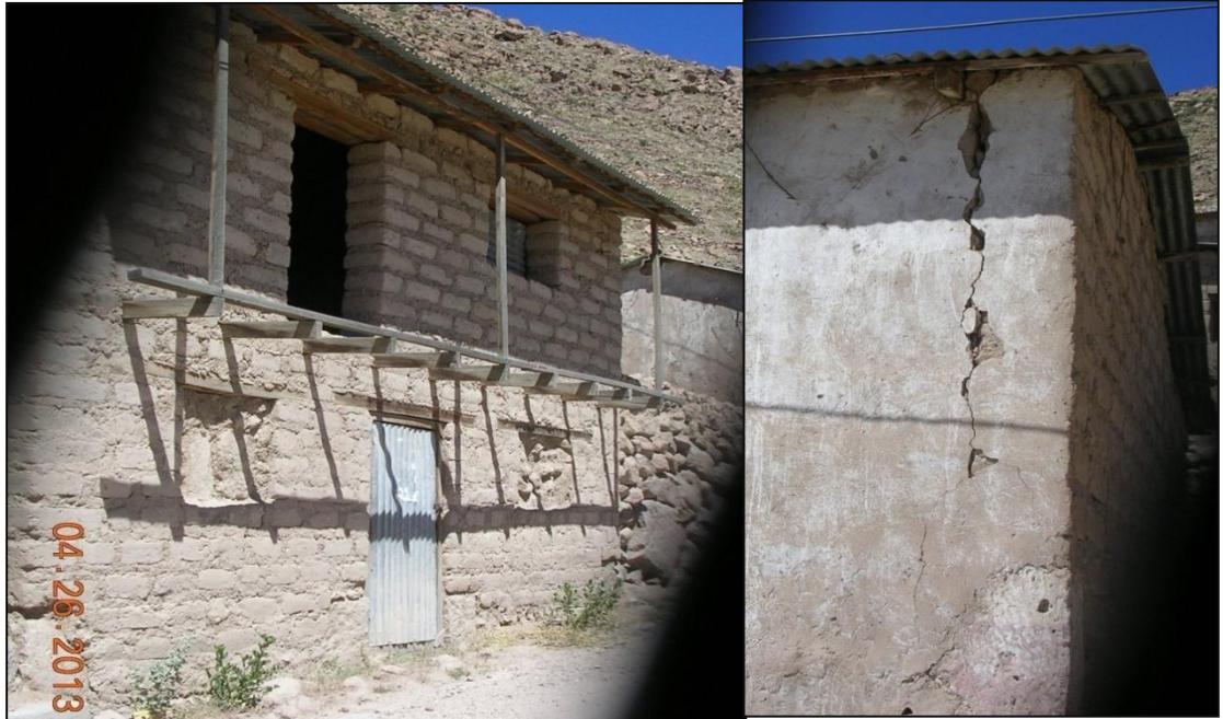
Fotografía 7: Vivienda del Centro Poblado de Ancocala. Se puede apreciar que la vivienda es de dos niveles usando el sistema constructivo tradicional de adobe. Sin embargo presenta grietas en los encuentros de muros.
