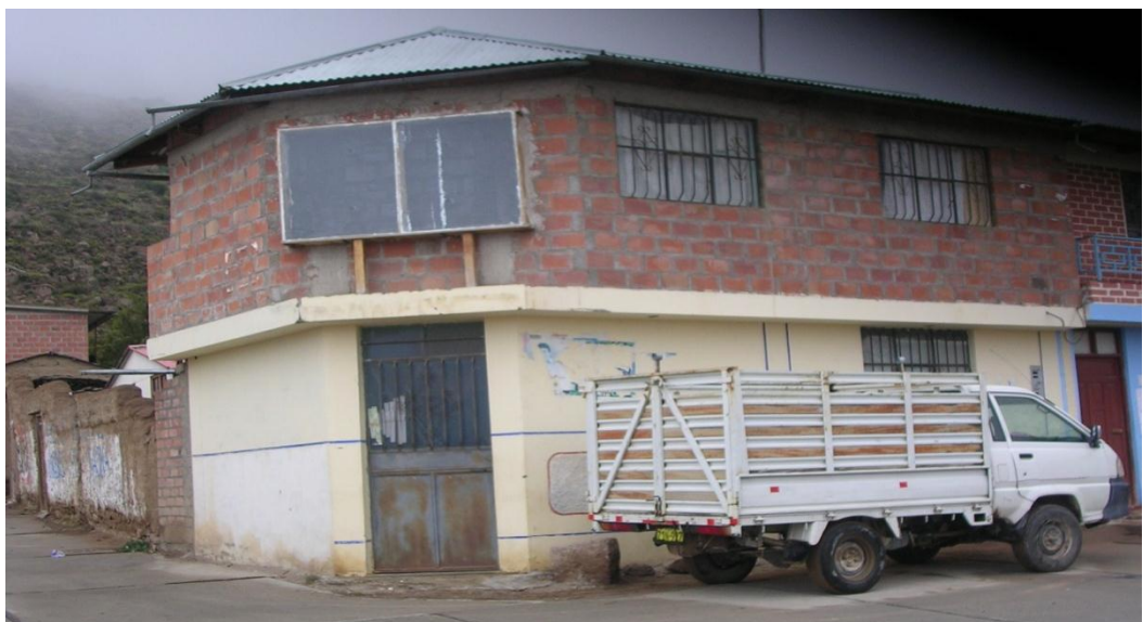
Fotografía 10: Vivienda del Centro Poblado de Yarabamba. La vivienda hace uso del sistema constructivo a base de ladrillo y cemento, implementado u muro trombe el mismo que por las características de los materiales usados no cumple la función de absorción y transmisión de calor.
