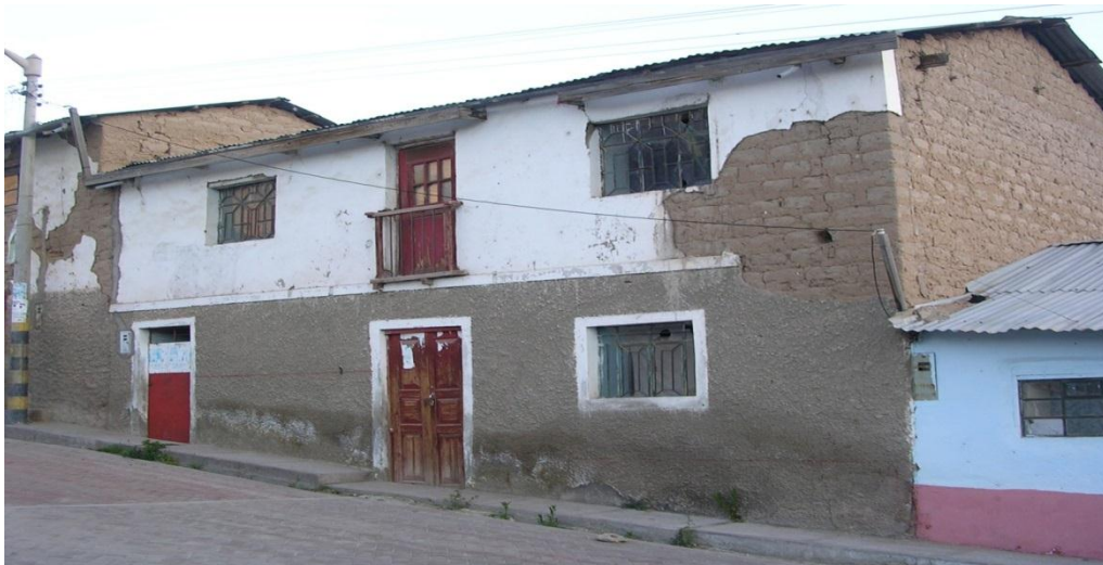
Fotografía 6: Vivienda ubicada en el pueblo de Cairani y construida bajo el sistema constructivo de adobe en sus dos niveles, se puede evidenciar daños estructurales a nivel de fisuras y grietas en los encuentros de muro.
