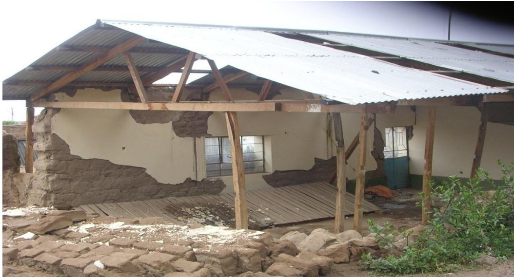
Fotografía 9: Vivienda del Centro Poblado de Yarabamba. Se puede apreciar que la vivienda ha colapsado debido a fallas estructurales. Nótese que las grietas han terminado por desprender los muros laterales
