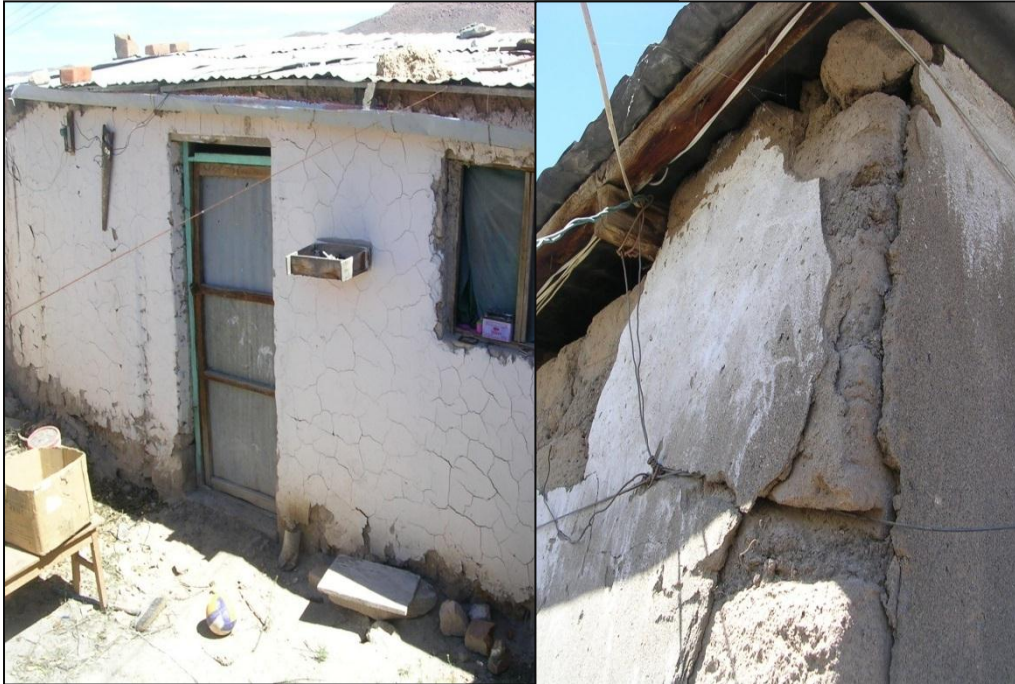
Fotografía 5: Vivienda construida bajo el sistema tradicional de adobe, se puede apreciar los daños estructurales a nivel de fisuras y grietas en los encuentros de los muros.
