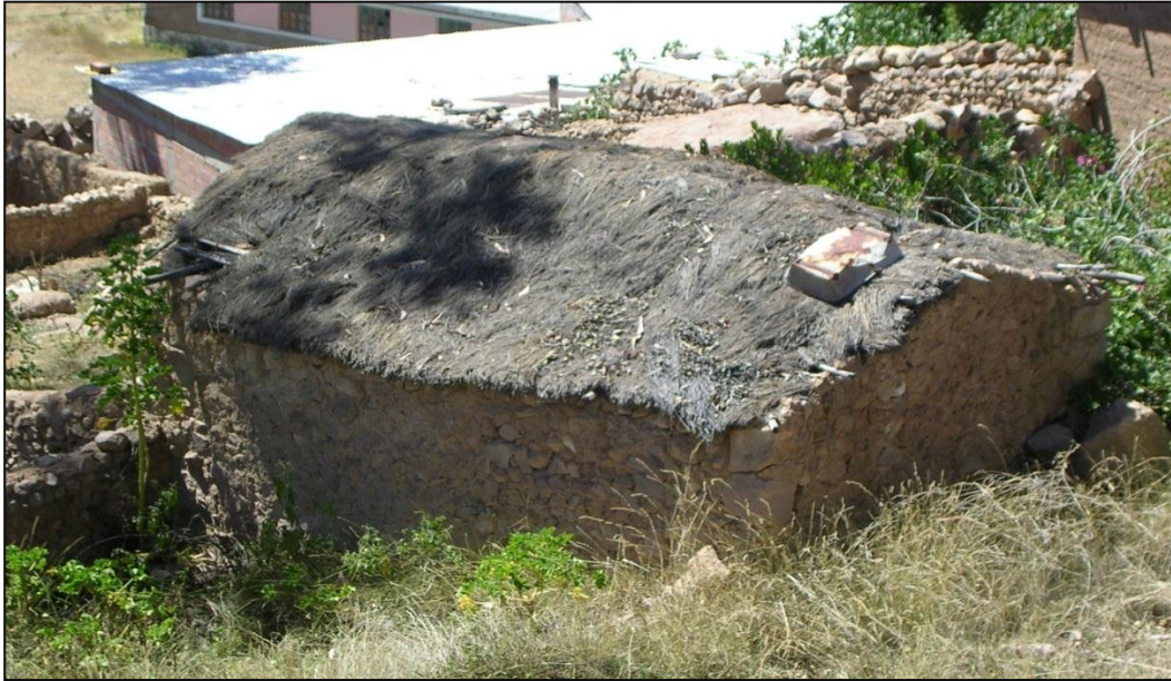
Fotografía 3: Vivienda Tradicional del distrito, donde se puede apreciar aun la cobertura en función a caña y paja, materiales que proporcionan mayor capacidad térmica
