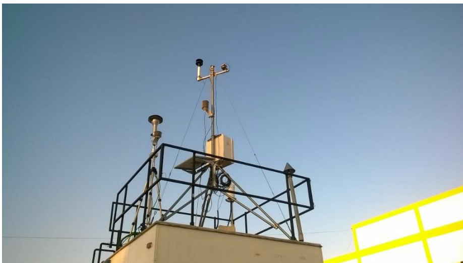
Figura 24. Vista del equipo instalado en la Loza deportiva de la ESME - UNJBG
