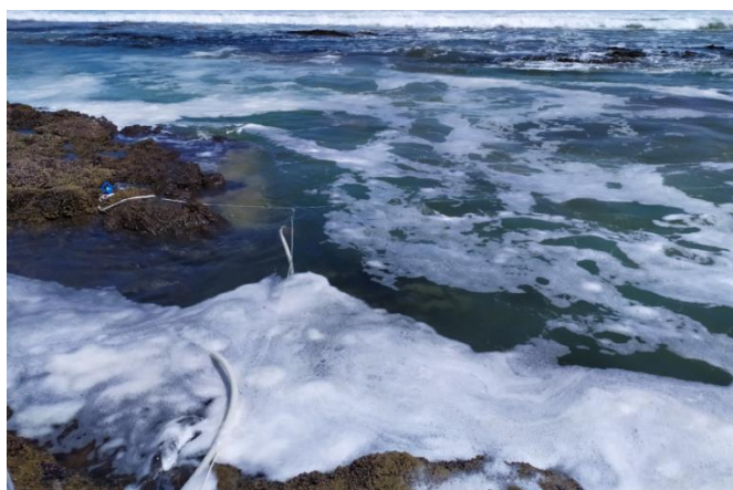
Figura 6 Sistema de sujeción de la bomba sumergible
