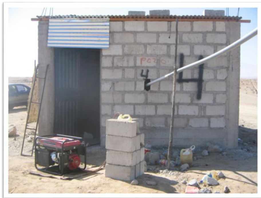
Foto Nº 28. Pozo P-4, con su caseta de bombeo.
