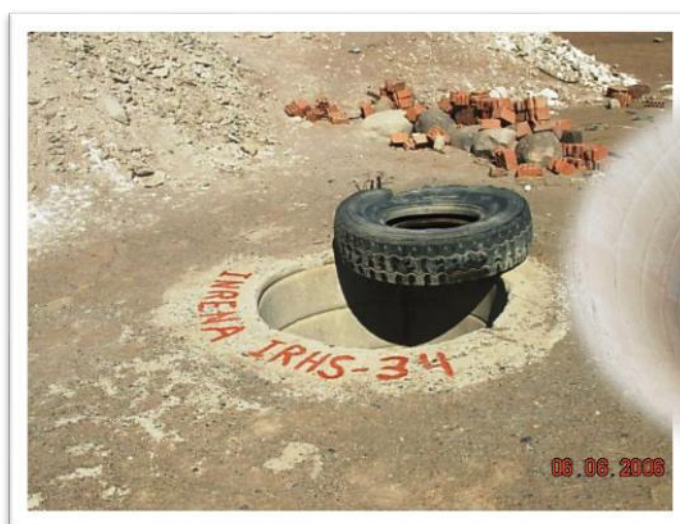
Foto N° 26 y 27. Pozo IRHS-34, de 110 m. de profundidad con un diámetro de 1.20 m. tal como se observa en la foto.
