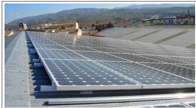
IMAGEN 58. MODULOS FOTOVOLTAICOS EN CUBIERTA
