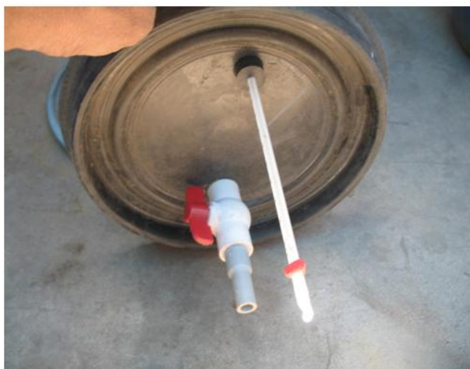
Figura 32: Tapa del biodigestor en su parte externa con el termómetro y la llave de paso de descarga de biogás en el instalado
