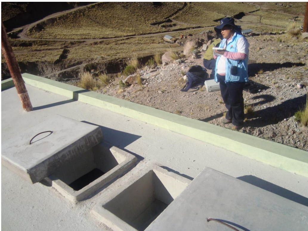
Foto N° 28: Sistemas de abastecimiento de agua para consumo humano que cuenta con una buena infraestructura en Ichuña
