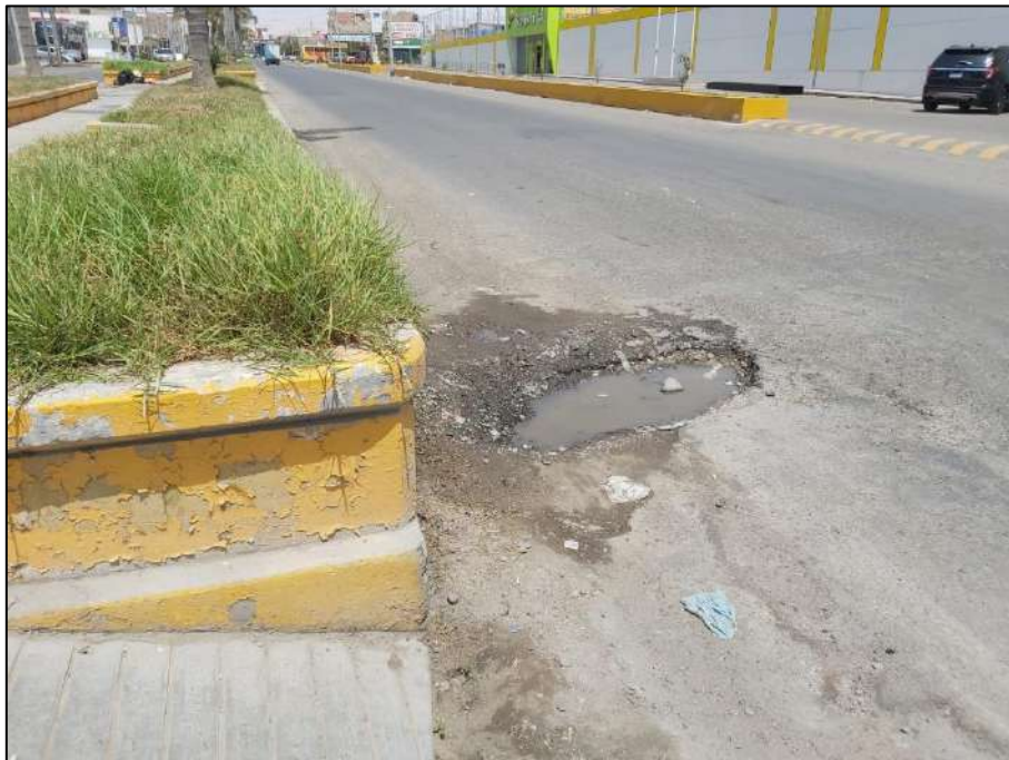
Falla existente en el pavimento flexible de la avenida industrial
