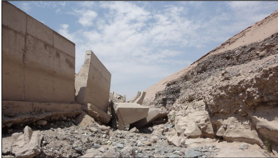
Figura 40: Colapso de los muros progresivas 0+670 y 0+680.
