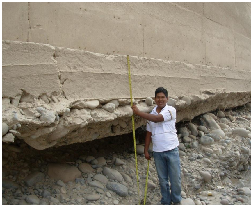
Figura 13 : Se muestra el grado de erosión del material de la cimentación originado por el paso de un caudal de 18,00 \text{ m}^3/\text{s} , ocurrido el año 2012
