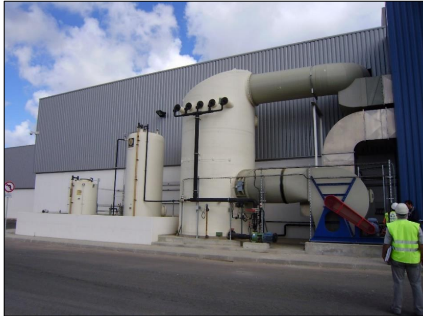
Imagen 42. Biofiltro instalado sobre la cubierta del edificio en túneles
