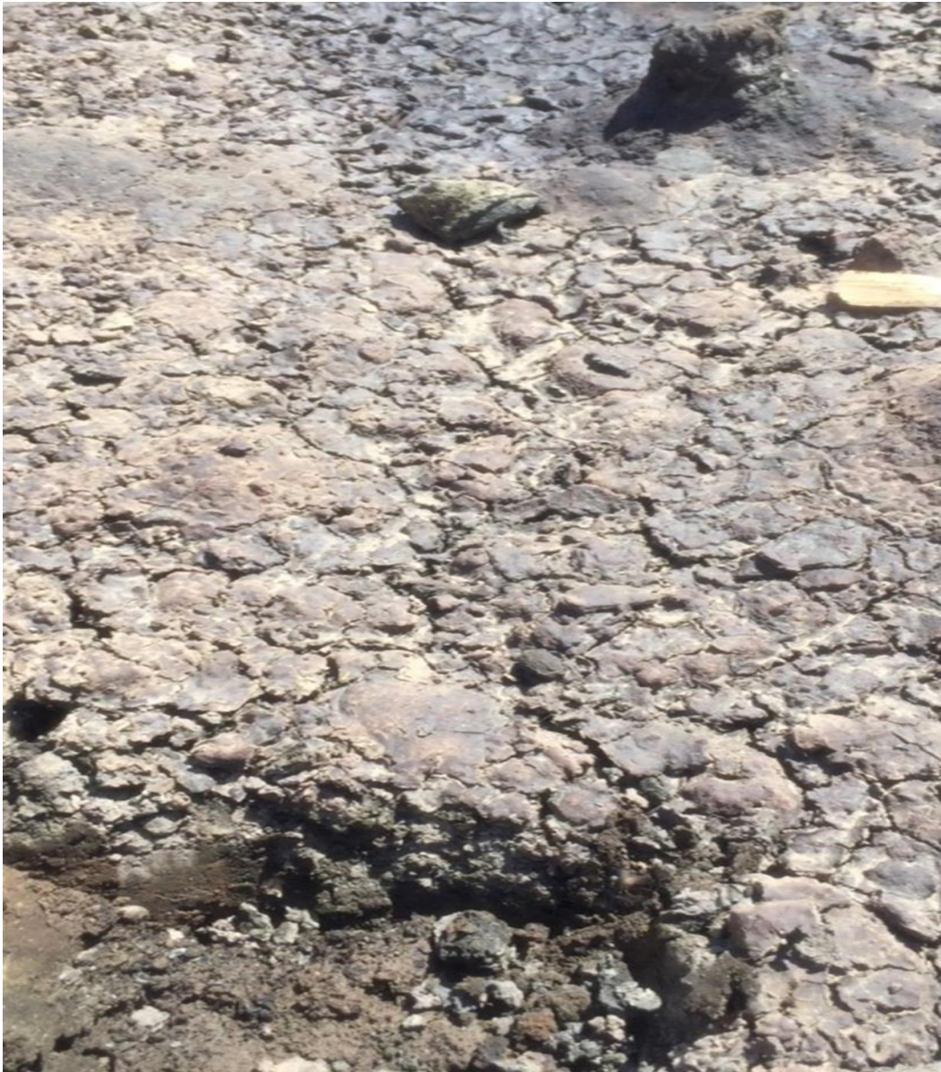
Imagen 5. Nivel de contaminación del suelo en el distrito de la Yarada Los Palos
