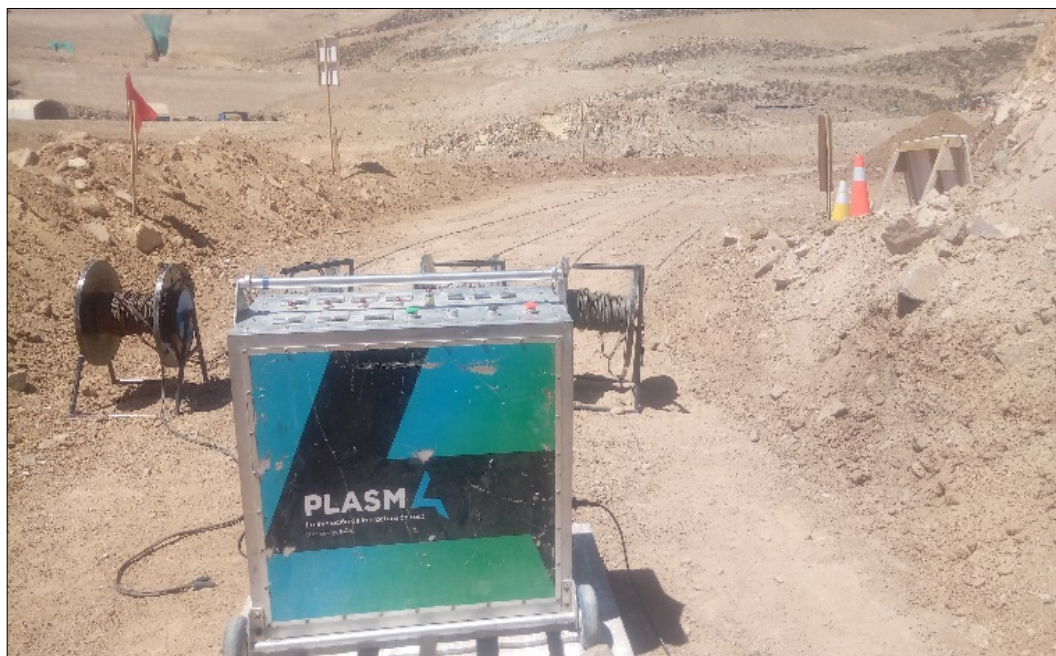
Ilustración 11. Equipo de circuito eléctrico de iniciación Fuente: ENAEX, 2019b.
