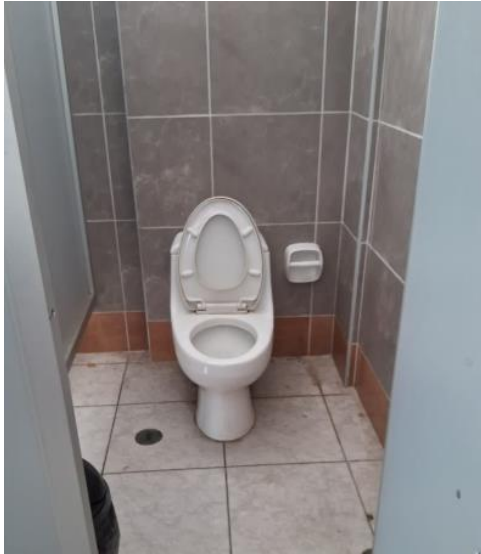
Inodoro SS.HH. 1 (Varones)
