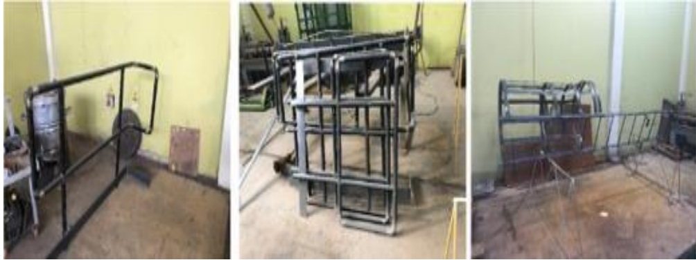
Figura 5. Acabado de apuntalado y soldeo de estructuras Fuente: empresa NCK Ingenieros E.I.R.L. (2018).
