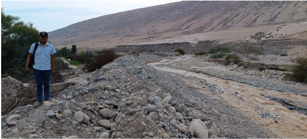
Fotografía 04: Se aprecia el tramo vulnerable del rio Caplina
