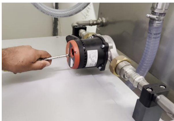
Purga de aire de la bomba.
