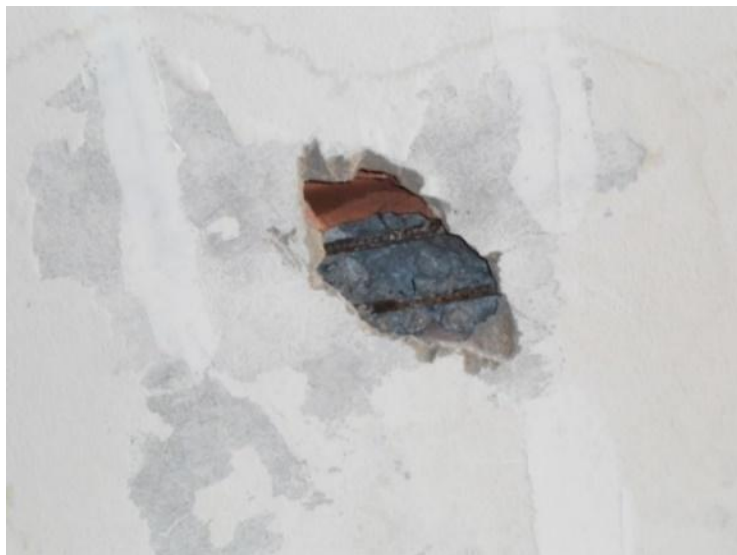
Figura 63. Acero corroído en vigueta de losa de 1° piso. Fuente: Elaboración propia.
