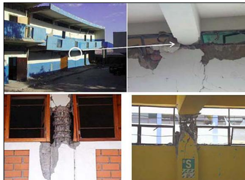
Figura 04. Colapso parcial y daños en escuelas por columnas cortas en Moquegua, Perú.
