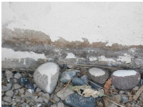
Figura 60. Humedad en el concreto aledaño a jardín.
