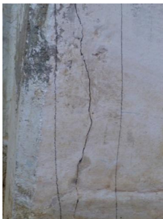
Figura 61. Fisura vertical en columna eje 6-A.
