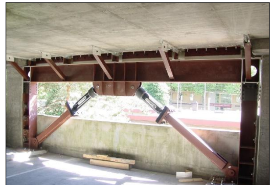
Figura 21. Disipadores en doble diagonal. Fuente: CDV, Lima Perú.
