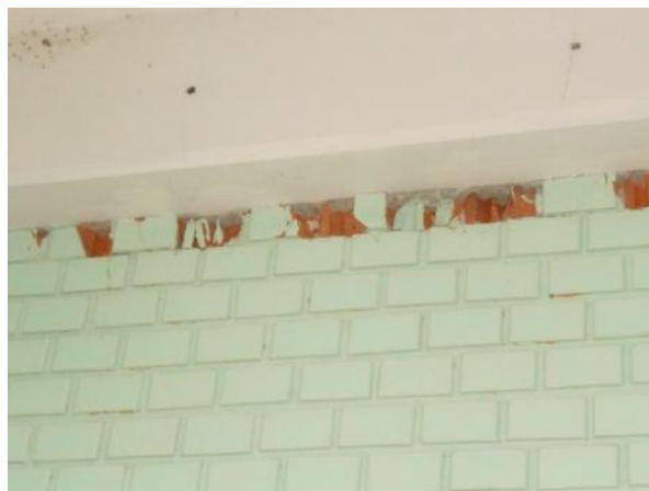
Figura 69. Trituración en muros de albañilería no aislados. Fuente: Elaboración propia.
