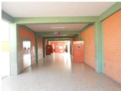
Figura 33. Muros con juntas insuficientes, 3° piso.
