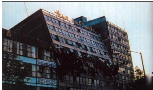
Figura 06. Falla debido al golpeteo entre edificios adyacentes que no coinciden en altura sus entresijos.
