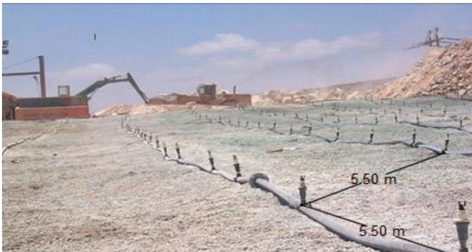
Figura 36. Distancia entre cada aspersor Fuente: Elaboración propia
