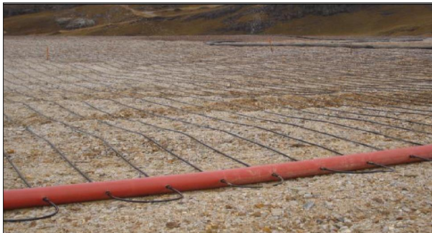
Figura 14. Módulos de riego por goteo Fuente: Módulo Lixiviación Alto Chicama
