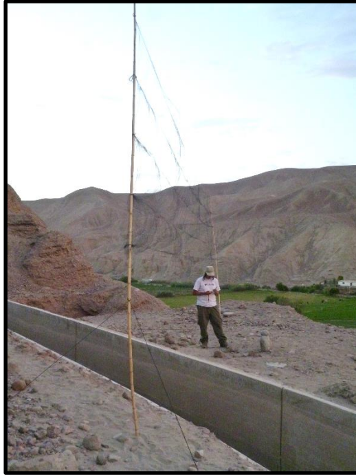
Foto 18. Instalación de redes de niebla en la localidad de Oconchay.
