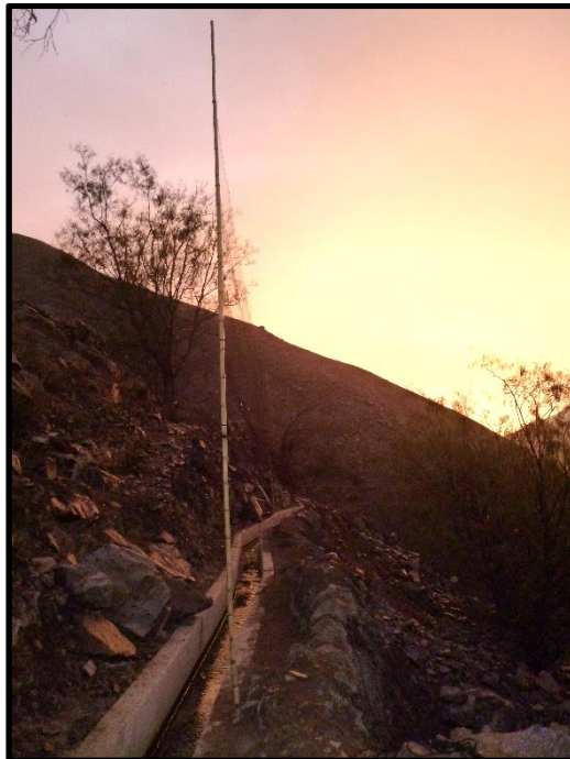
Foto 23. Instalación de redes de niebla en la localidad de Toco Grande.
