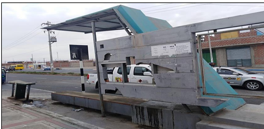
Figura 49. Mobiliario urbano en mal estado
