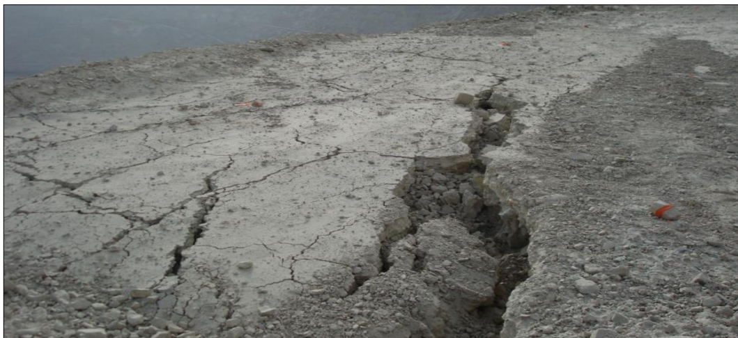
Figura 39. Daño de paredes del tajo por vibraciones Fuente: SPCC, 2018.
