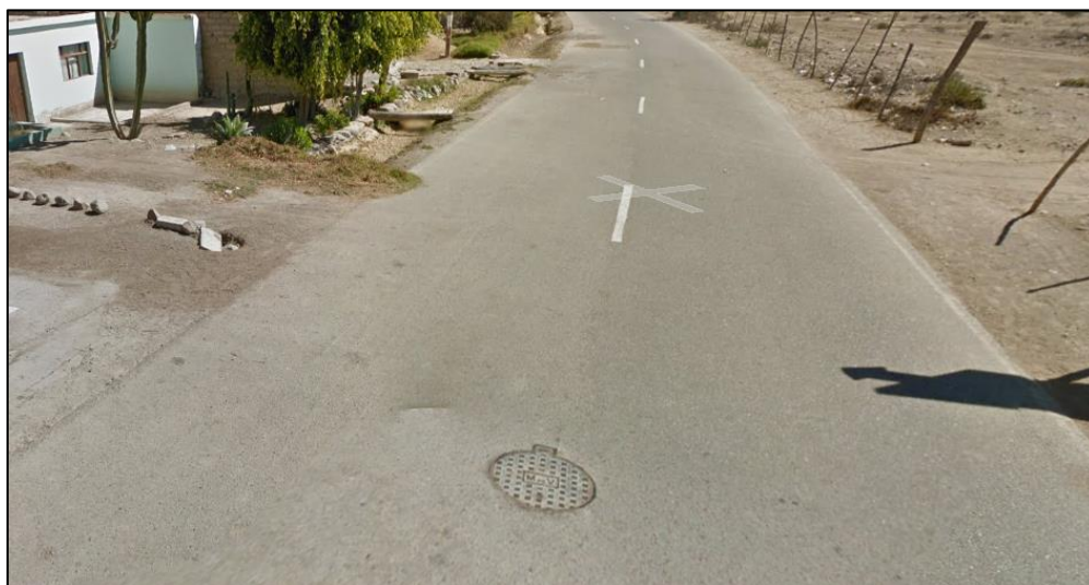
Figura N° 39. Vista del desagüe en la vía principal Tacna – Calana – Pachía Fuente: Elaboración propia
