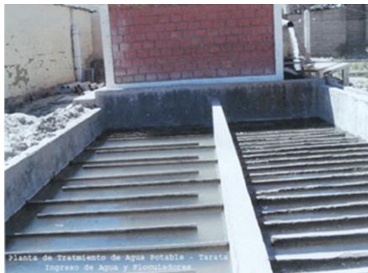
Figura 48: planta de tratamiento de agua potable de Tarata Fuente: (Municipalidad Provincial de Tarata, 2007) Elaboración: (Municipalidad Provincial de Tarata, 2007)
