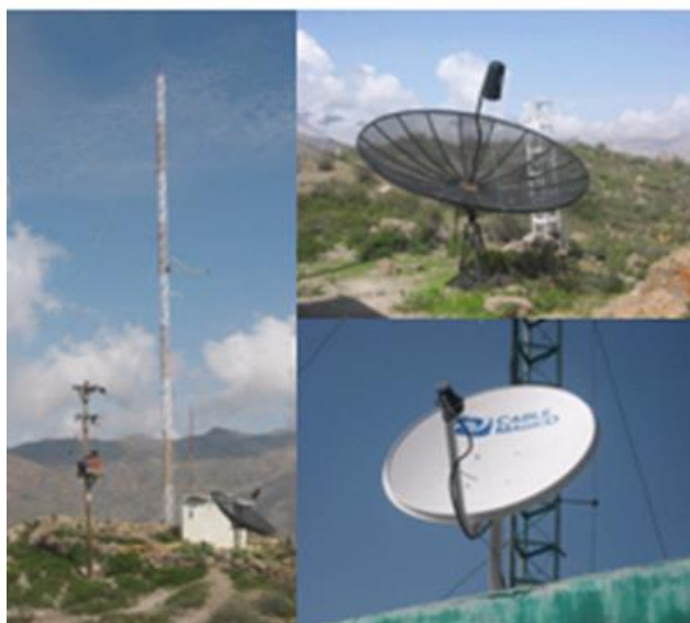
Figura 52: Imágenes de antenas de telecomunicación y de radio en Tarata
