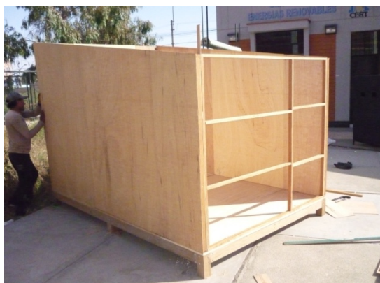
Figura 24: Vista general de caja aislada térmicamente.
