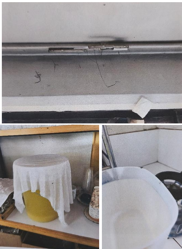
Presencia de insectos y deficiencia de limpieza en el local
