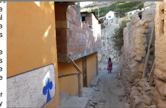
VIVIENDA EN ESTADO DE DETERIORO
