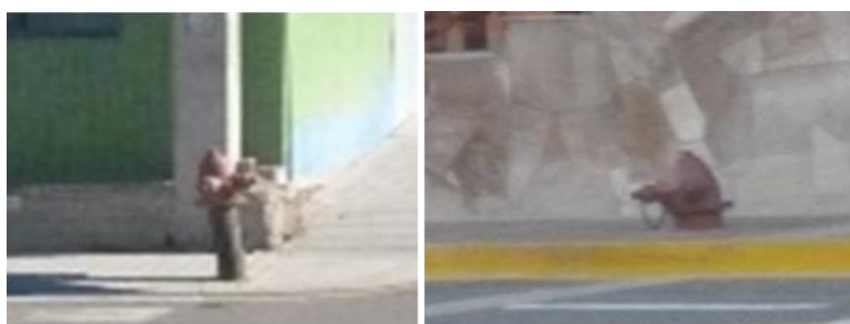
Figura 61. Hidrante contra incendio. Producción propia (2018).
