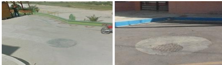
Figura 62. Buzón de desagüe. Producción propia (2018).
