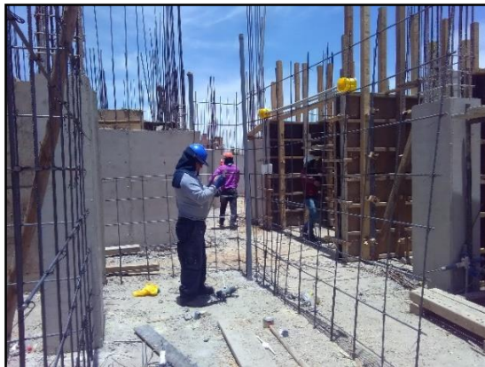
Fotografía 06. Instalaciones eléctricas en muros de cerramiento (salida y entubado)
