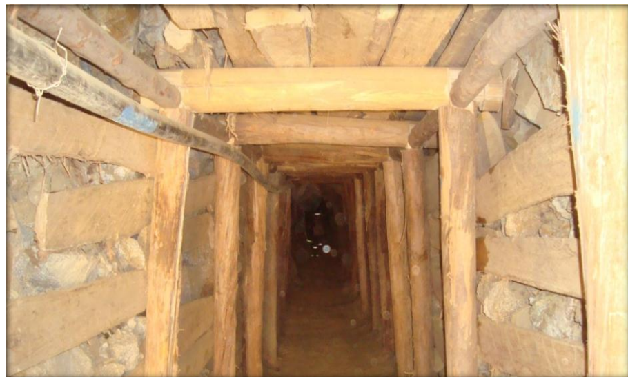
Figura 4. Sostenimiento (cuadros de madera)
