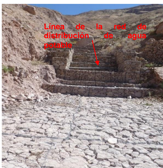
Figura 22: Disipadores de energía en la quebrada Alta Misa Fuente: Elaboración propia, 2015
