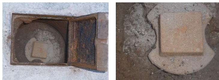
Figura 14: Válvula de sectorización Fuente: Elaboración propia, 2015
