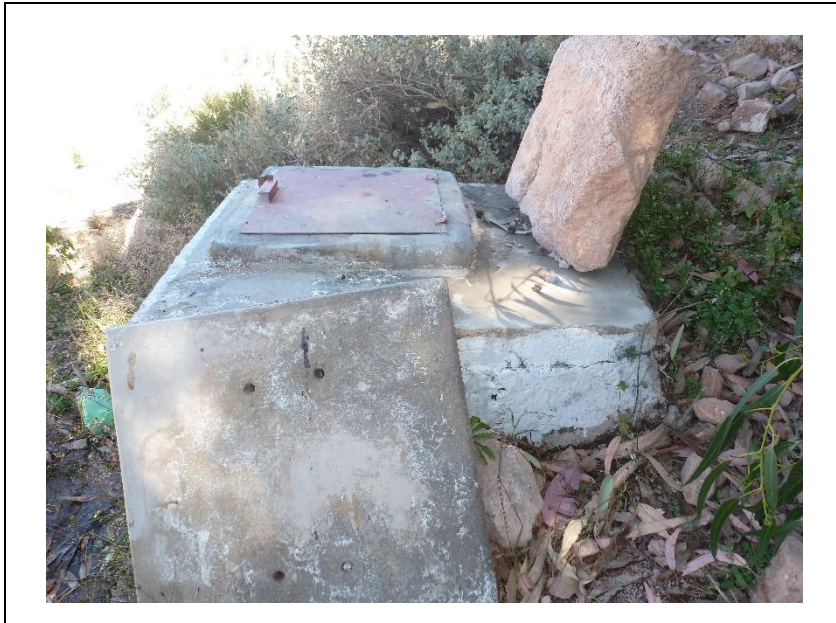
Fotografía N°05: Cámara rompe presión no presenta cerco de protección.
