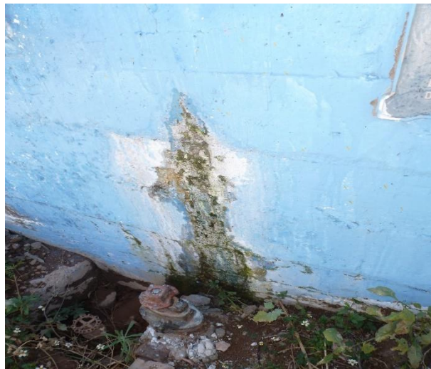
Fotografía N°04: Válvulas de control del reservorio antiguo, no cuenta con caja de concreto se encuentra oxidado.
