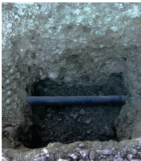
Figura 12: Inspección de la red de distribución de agua potable en la calle El Mirador Fuente: Elaboración propia, 2015
