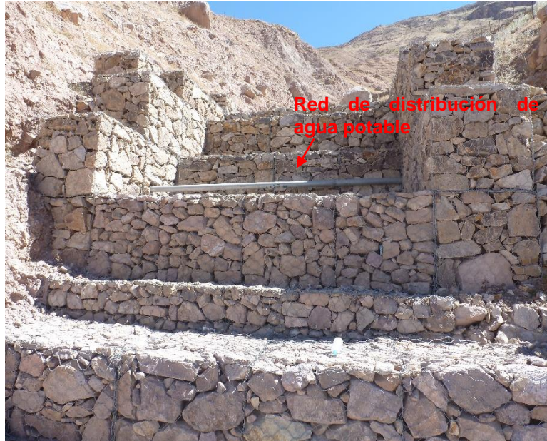
Figura 49: En la quebrada Alta Misa la red distribución de agua potable se encuentra expuesta
