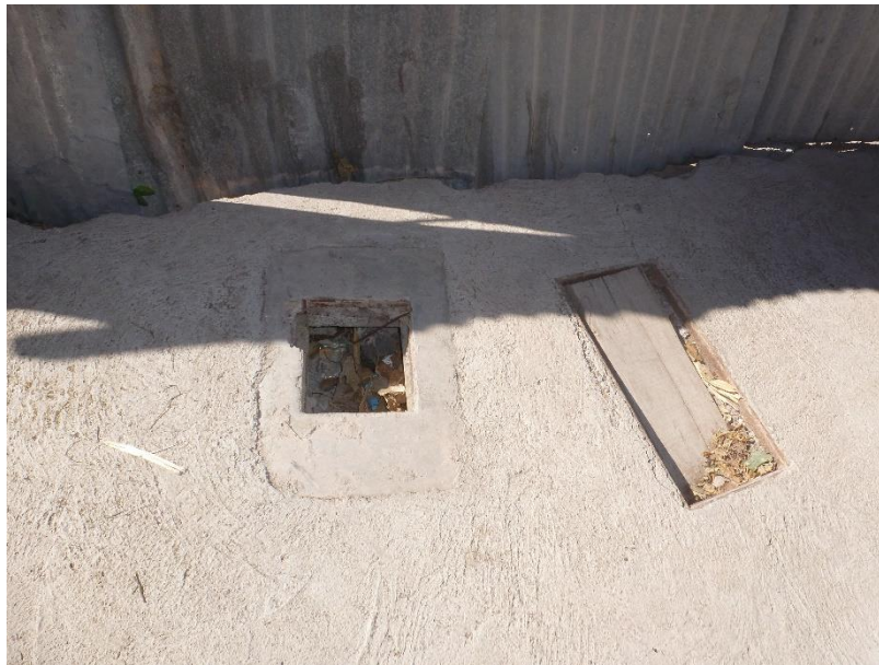
Fotografía N°09: No presentan tapa la caja de válvula de conexión domiciliaria, y caja de alcantarillado en la calle San Cipriano.
