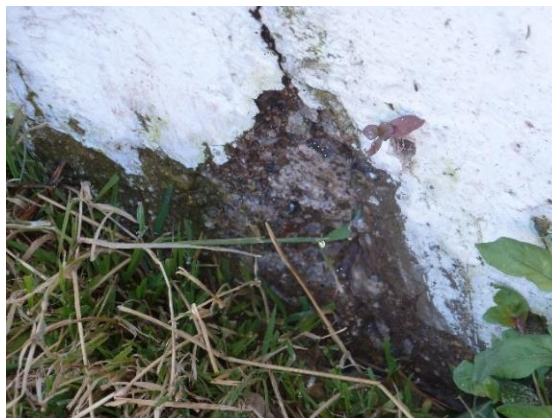
Figura 11: Grietas de la Cámara rompe presión Fuente: Elaboración propia, 2015
