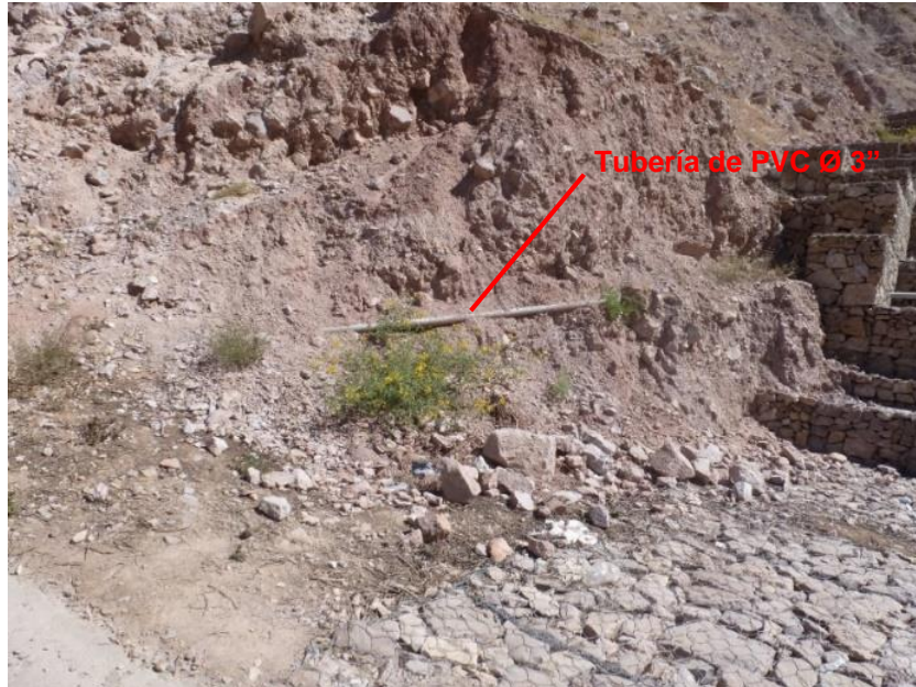
Figura 51: Red de distribución de agua potable expuesta en la vía Nueva Visión próxima a la quebrada Alta Misa. Fuente: Elaboración propia
