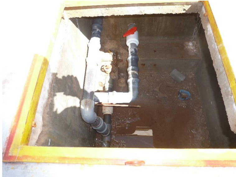
Fotografía N°02: Válvulas de control del reservorio han sido cambiadas recientemente.
