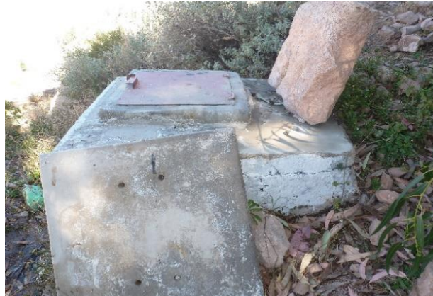
Figura 10: Cámara rompe presión Fuente: Elaboración propia, 2015
