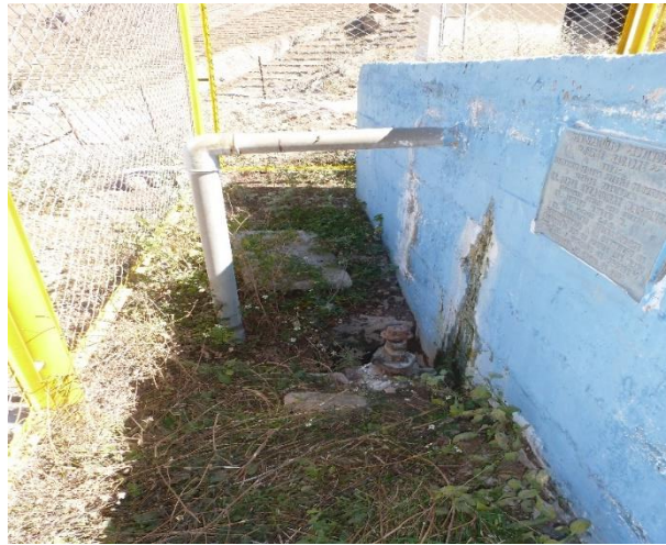
Fotografía N°03: Reservorio de agua potable construido en los años 90, actualmente fue acondicionado por los pobladores para tener mayor capacidad de almacenamiento.
