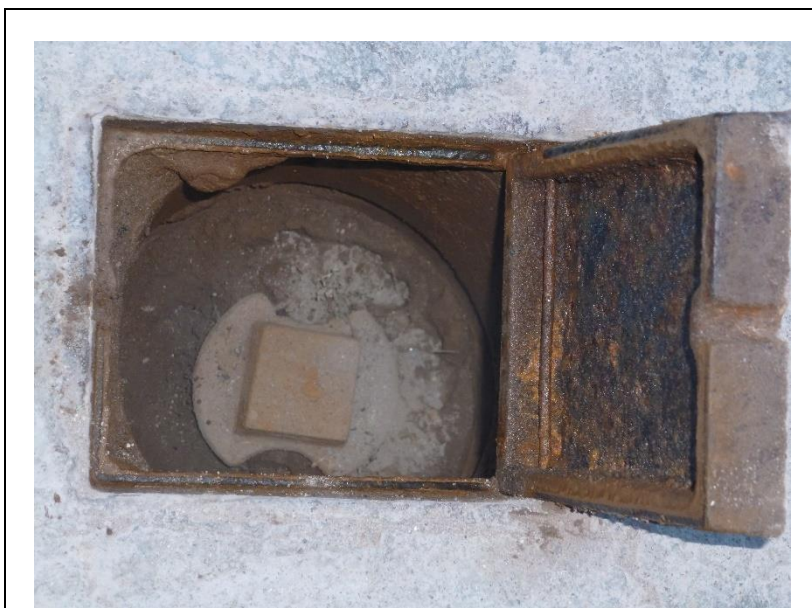
Fotografía N°08: Válvulas de sectorización se encuentran oxidados.
