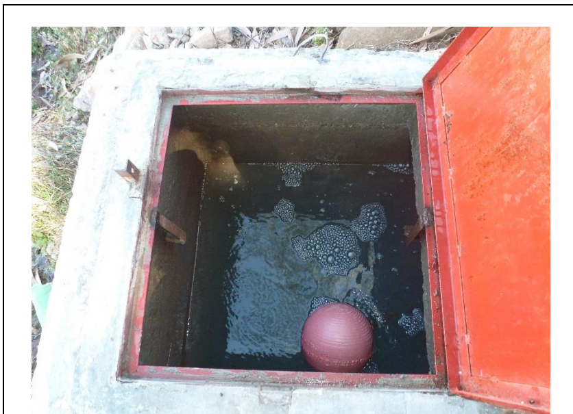
Fotografía N°06: Cámara rompe presenta una boya para regulación.
