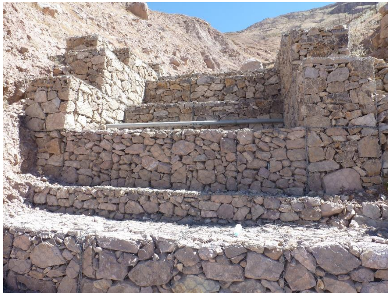
Fotografía N°15: La red de distribución de agua potable se encuentra expuesta en la quebrada Alta Misa.
