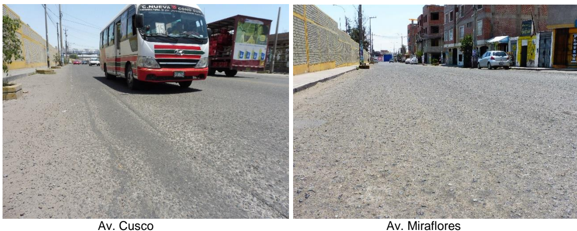
Figura 11. Estado de la carpeta asfáltica de las Avenidas Cusco y Miraflores.
